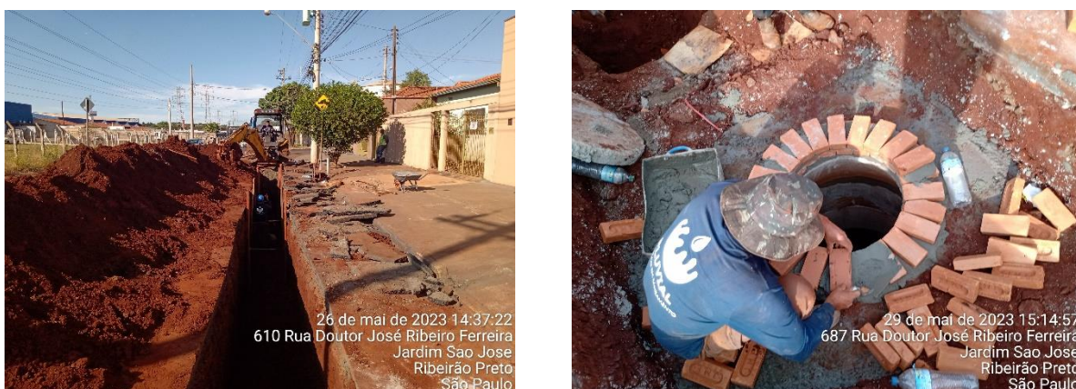
Figura TEC 19– Coletor Tronco Santa Rita do Picadão (Fonte: SAERP)
