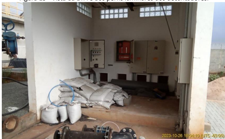
Figura 21 - Painéis elétricos da ETA.
