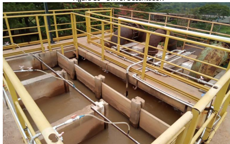
Figura 12 - Caixa de chegada de água bruta para toda a ETA.
