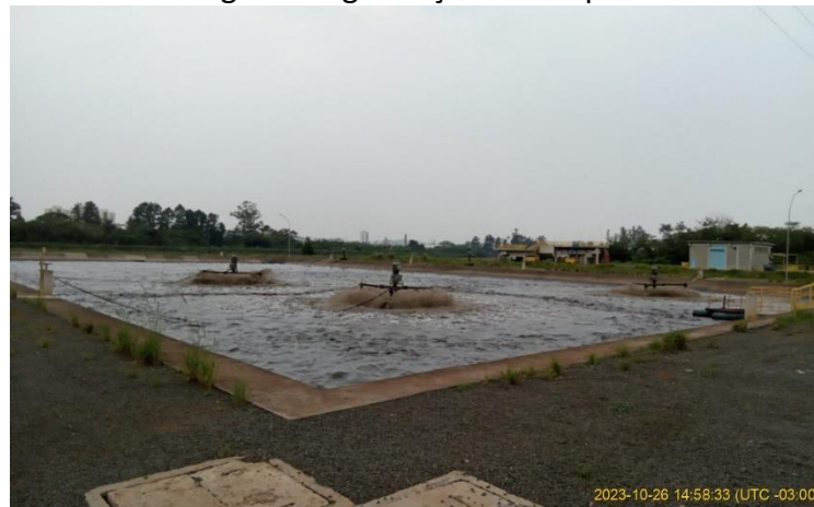
Figura 14 - Segunda lagoa de seis aeradores da ETE.
