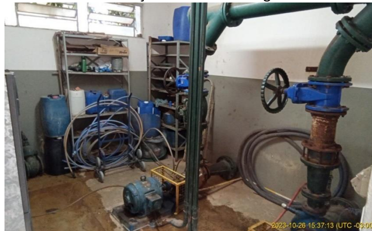
Figura 2 - Moto bombas da EEAB atual que serão substituídas.
