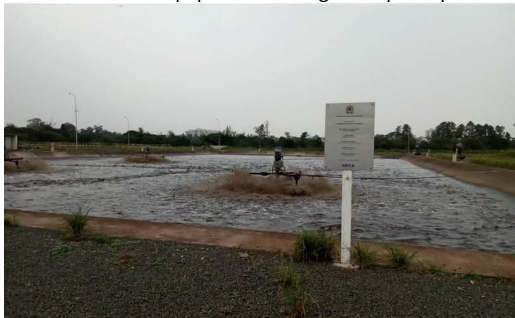
Figura 13 - Segunda lagoa de seis aeradores da ETE.
