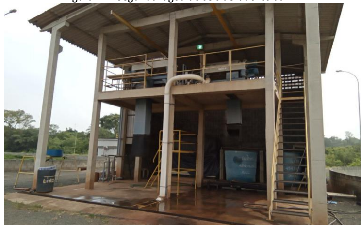
Figura 16 - Sistema de tratamento de lodo da ETE.
