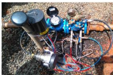
VRP e Medidor de vazão
