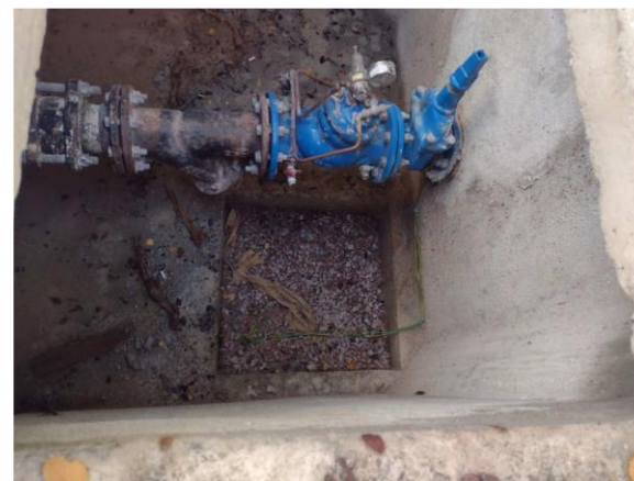
Foto 4 – Válvula redutora de Pressão e Macromedidor em caixa abrigo – Zona Sul de Jundiaí (Fonte: DAE, 2023).
