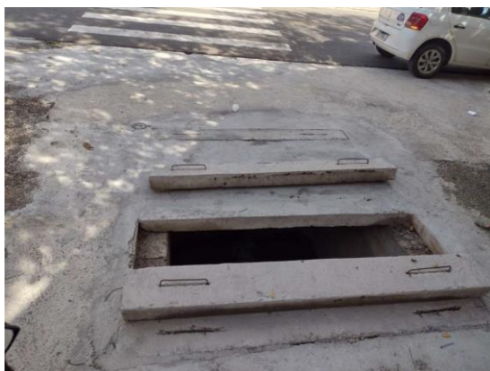
Foto 3 – Local de implantação de Válvula Redutora de Pressão e Macromedidor em passeio da via - Zona Sul de Jundiaí (Fonte: DAE, 2023).
