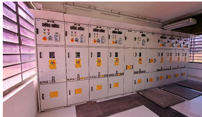
Foto 2 – Novos painéis de acionamento dos conjuntos motobomba da EEAB Rio Jundiá Mirim.
