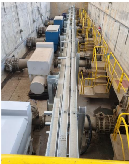
Foto 3 – Novas instalações para fios elétricos na sala dos conjuntos motobomba da EEAB Rio Jundiá Mirim.
