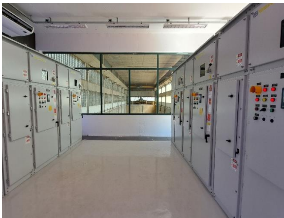
Foto 1 – Novos painéis de acionamento dos conjuntos motobomba da EEAB Rio Jundiá Mirim.
