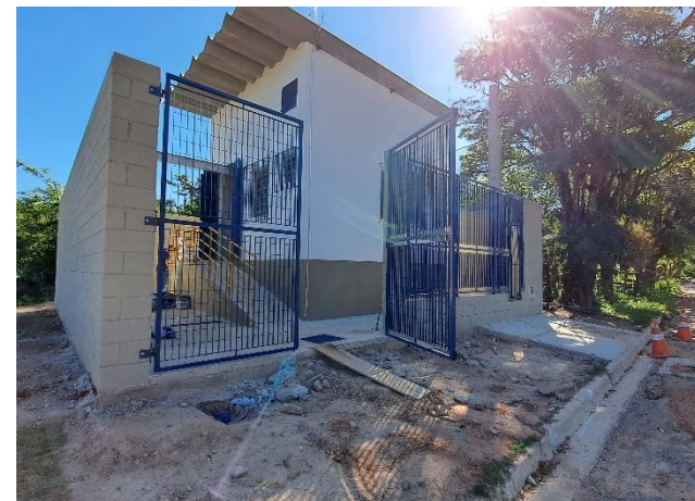
Foto 3 – Vista externa do novo Booster do Bairro Vivendas.
