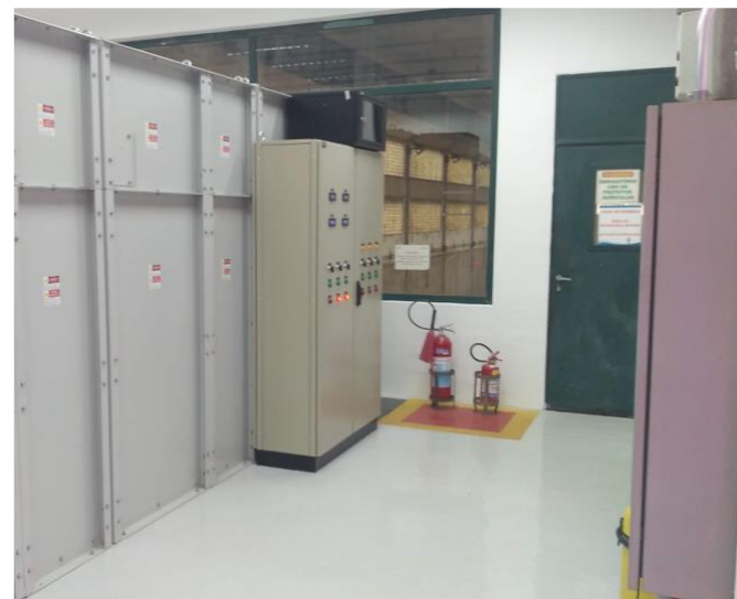
Foto 4 – Novas instalações elétricas da EEAB Rio Jundiá Mirim.
