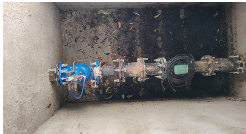
Foto 2 – Válvula redutora de Pressão e Macromedidor em caixa abrigo – Zona Leste de Jundiaí (Fonte: DAE, 2023).
