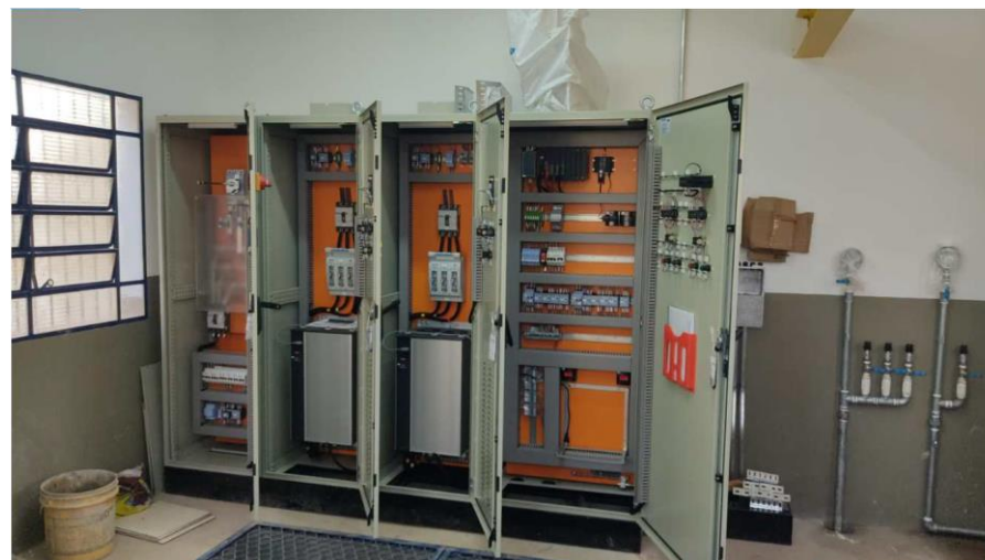
Foto 4 – Painéis elétricos da EEAT Mato Dentro (Fonte: DAE, 2023).
