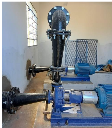
Foto 2 – Vista interna dos conjuntos motobomba e instalações hidráulicas do novo Booster do Bairro Vivendas.
