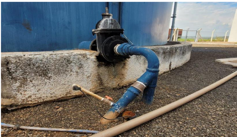
Foto 1 – Tomada de pressão na saída de reservatório de água tratada. Fonte: SAAEDOCO, 2023.
