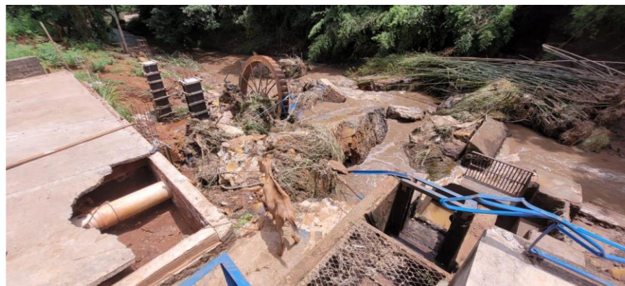
Figura 3 – Situação da Captação do Lajeado após rompimento da Barragem em dezembro de 2022. Fonte: SAAEDOCO, 2023.
