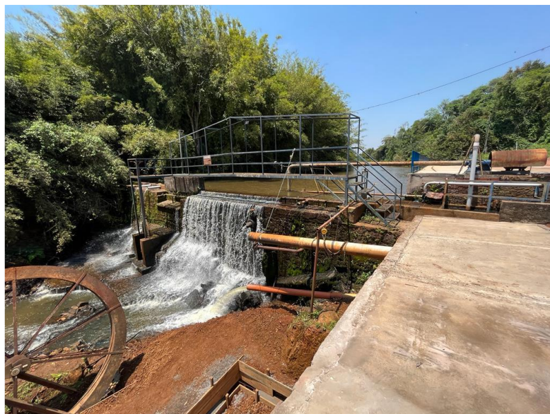
Figura 1 – Barragem do Lajeado antes do rompimento. Fonte: SAAEDOCO, 2023.
