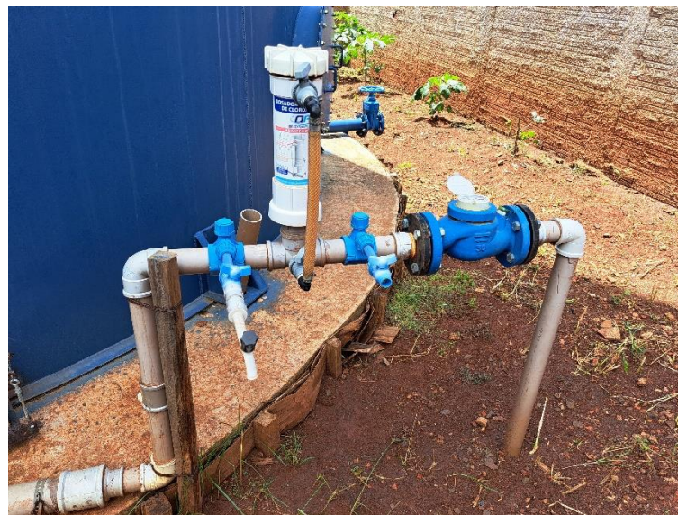
Fotos 2 – Macromedidor e sistema de cloração na chegada da água ao Reservatório Bom Jardim.
