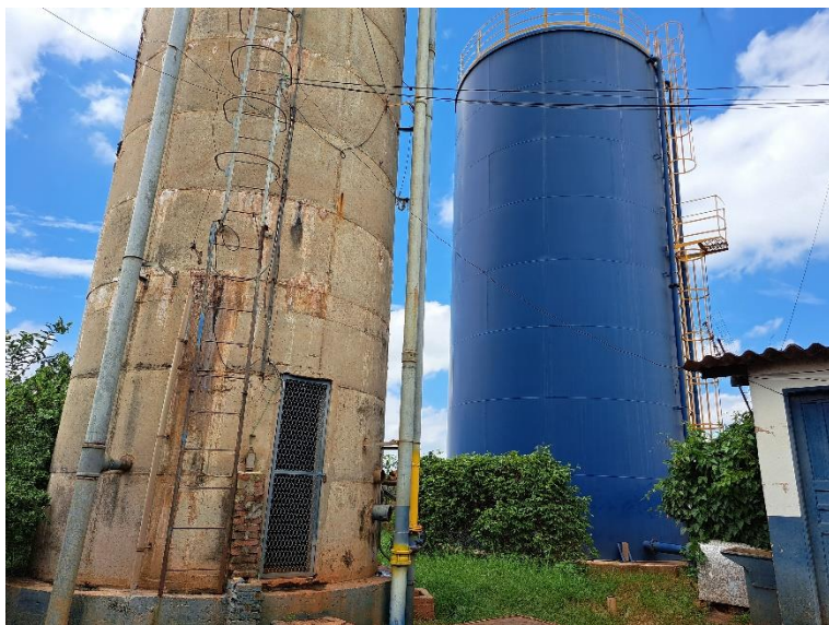
Fotos 1 – Novo Reservatório (azul) do Bairro Bom Jardim, ao lado do antigo Reservatório ainda em operação.
