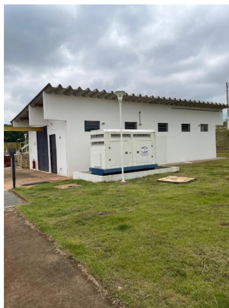
Figura TEC 7 – Gerador de energia na ETE Barrocão.
