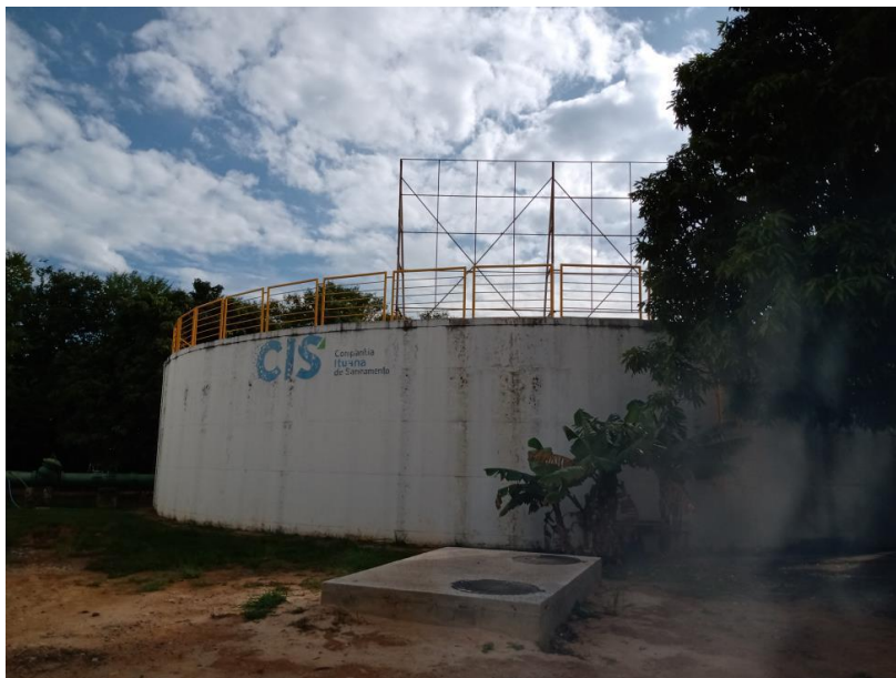
Foto 4 – Guarda-corpos no Reservatório Apoiado Vila Rica.
