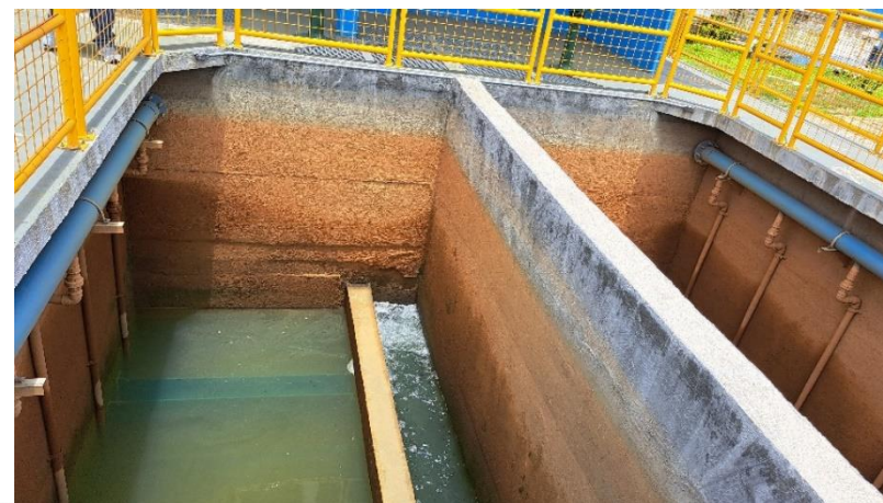
Foto 2 – Vista interna de um dos novos filtros da ETA I
