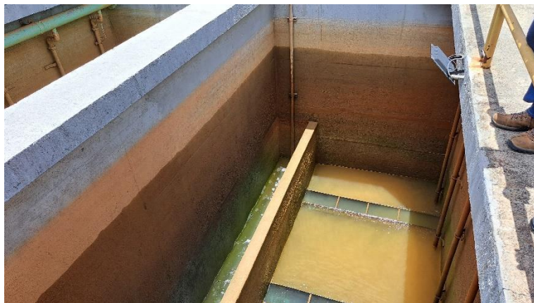
Foto 1 – Unidade antiga de filtro da ETA I após troca de elementos filtrantes
