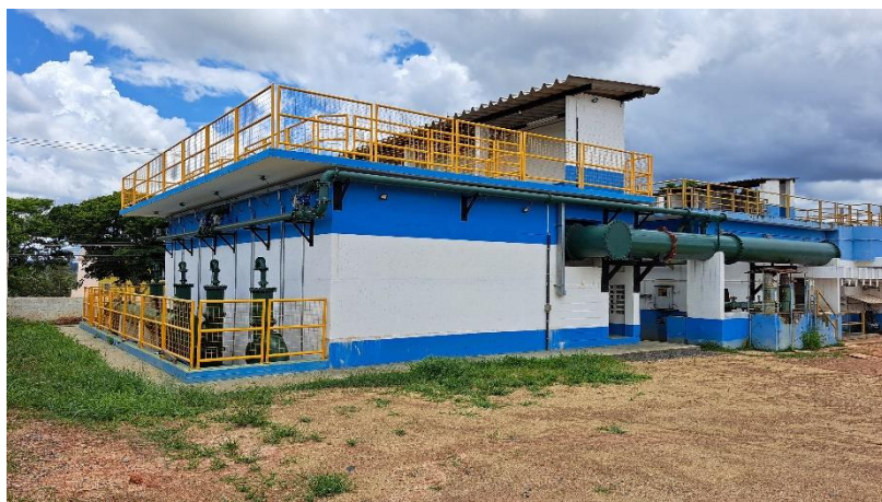
Foto 1 – Vista externa dos novos filtros da ETA I
