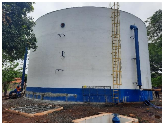
Figura TEC 2- Reservatórios Pq. São Sebastião (2.000 m 3 )
