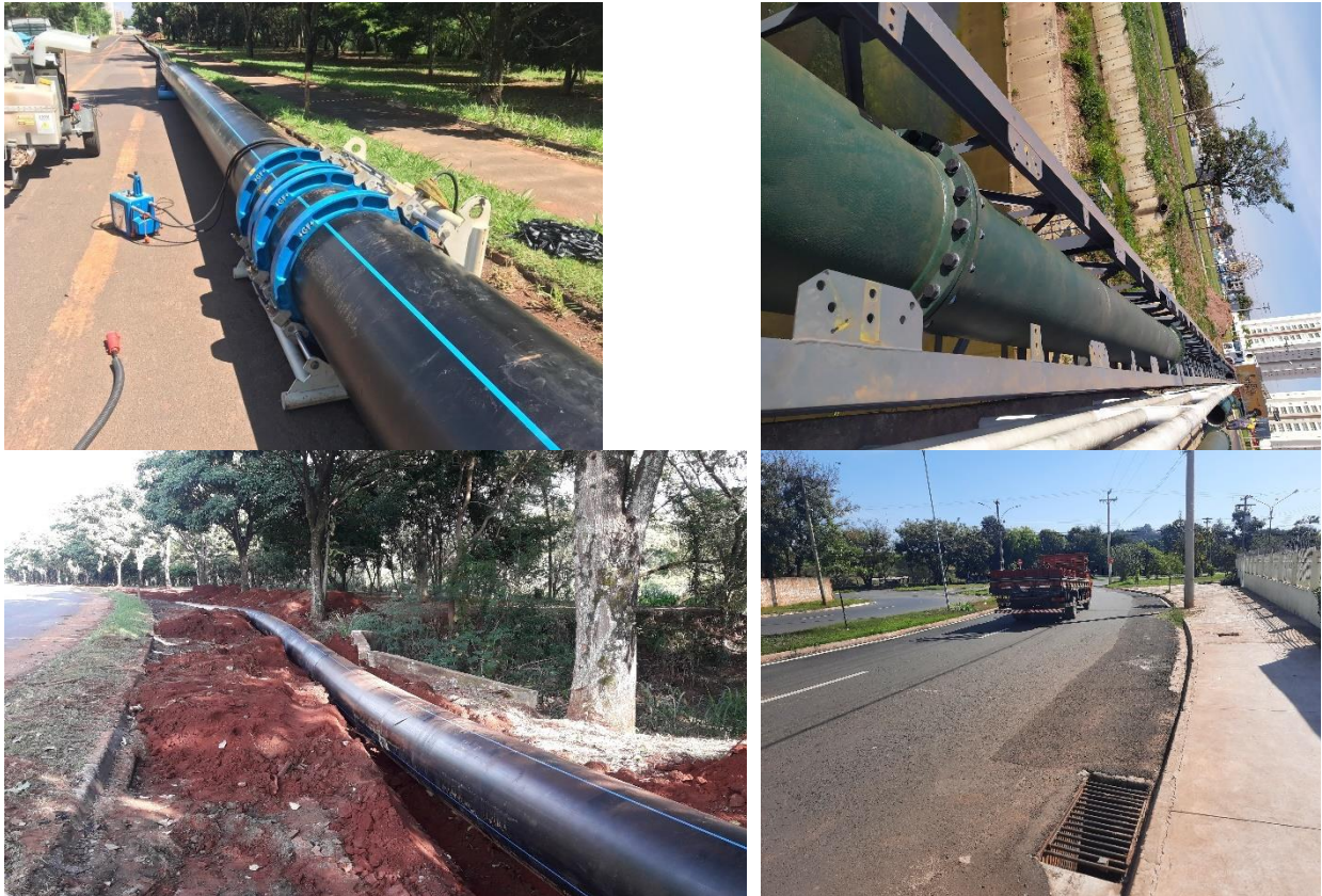
Figura TEC 2 –Construção de adutora de 7 km no SABAZ Leste (Fonte: Arquivo SAEMA)
