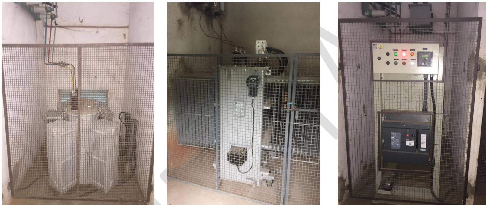
Figura 5. Troca de dois transformadores de energia e de disjuntor de proteção de média tensão - Captação de Água do rio Jaguari
