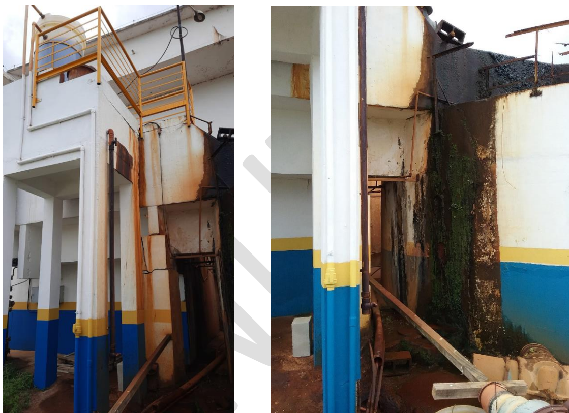
Figura 9. Unidade da ETA Central com patologias na construção: recomenda-se a realização de estudos para avaliar a segurança da estrutura e a reforma das unidades. Foram identificadas patologias como infiltrações, fissuras, trincas, armaduras expostas e vazamentos, podendo causar riscos à operação, eficiência e segurança da ETA.
