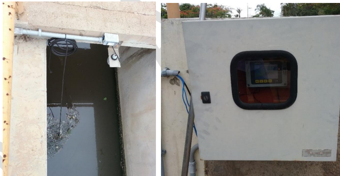
Figura 1. Medidores de vazão ultrassônico na ETE
