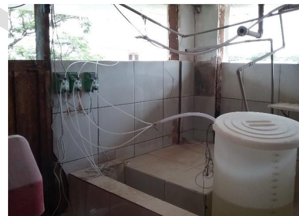
Figura 6. Bombas dosadoras na ETA
