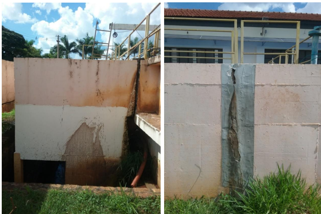
Figura 3 - Parte da estrutura da ETA danificada
