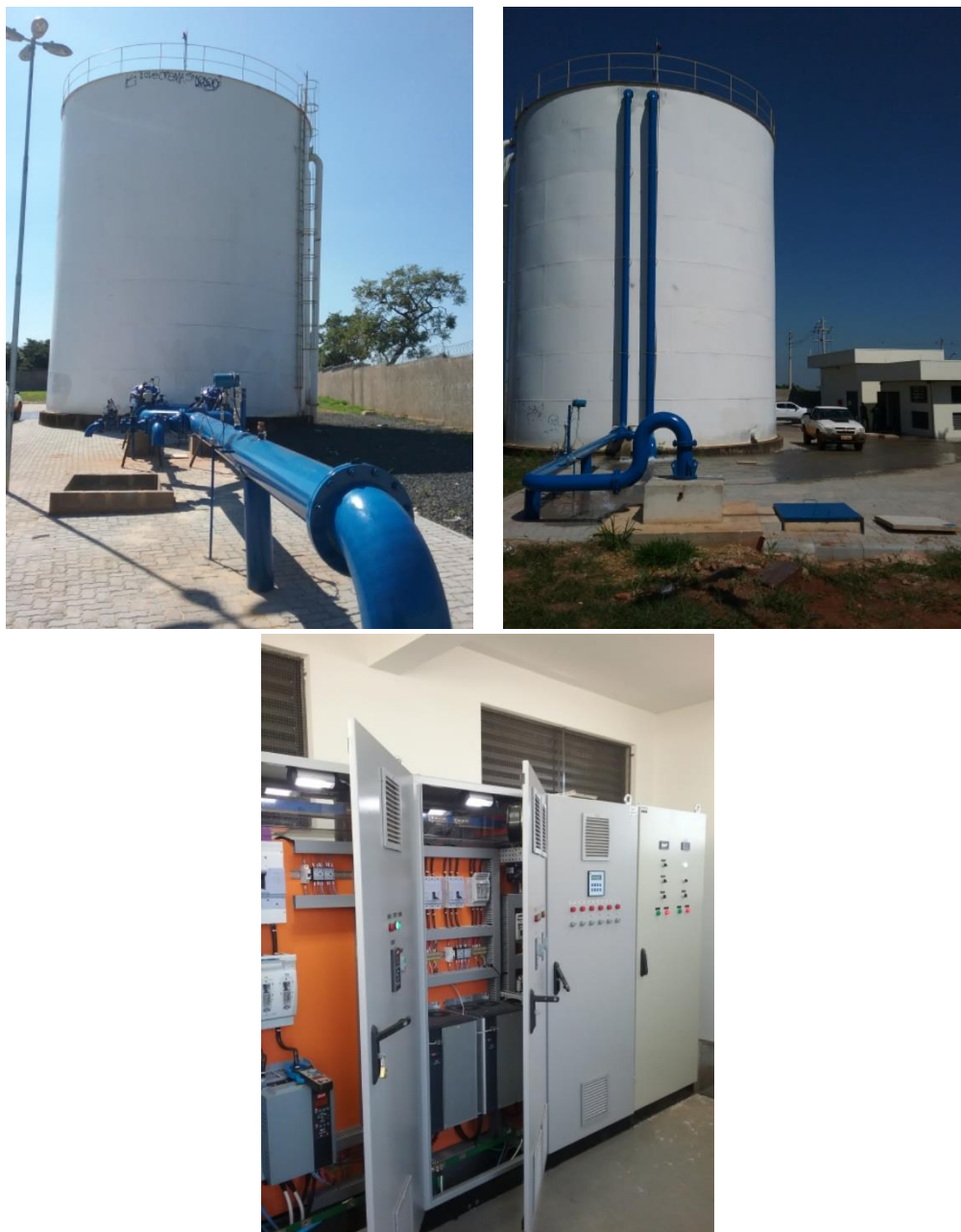
Figura 4 - Centro de Reservação e Poço Victorio de Santi II
