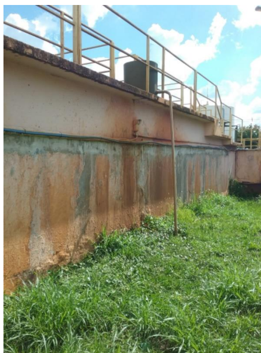
Figura 2- Vazamentos apontados sanados
