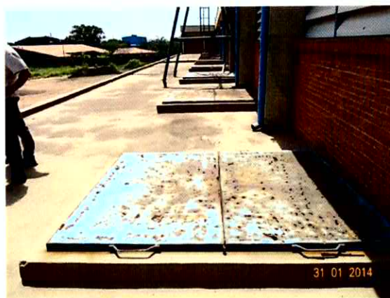
Figura 09- Tampas de inspeção apresentam corrosão e deverão ser substituídas
