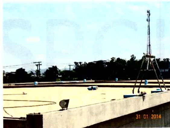
Figura 08 – Detalhe do reservatório apoiado da central de distribuição
