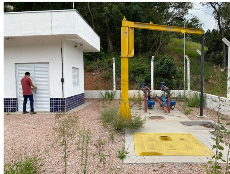
Elevatória de Esgoto San Diego 2
