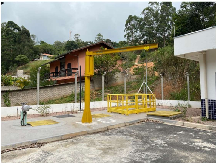
Elevatória de Esgoto San Diego 1
