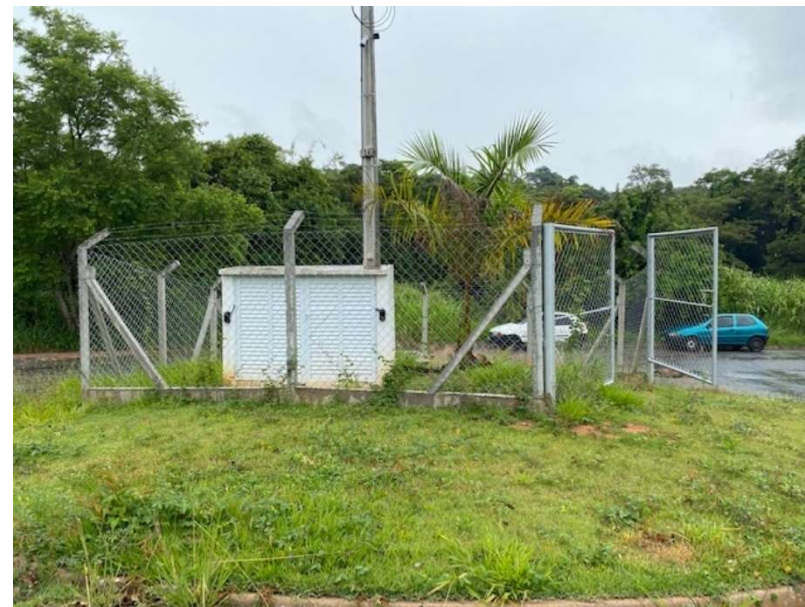
Elevatória de Esgoto do Distrito Industrial (Alzira Cicchetto)
