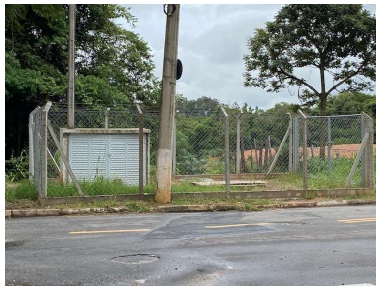
Elevatória de Esgoto Santa Claudina
