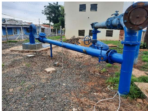
Figura TEC 3- Poço Tubular Profundo Iguatemi
