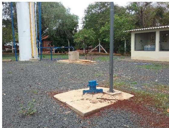
Figura TEC 2- Poço Tubular Profundo Assentamento Bela Vista
