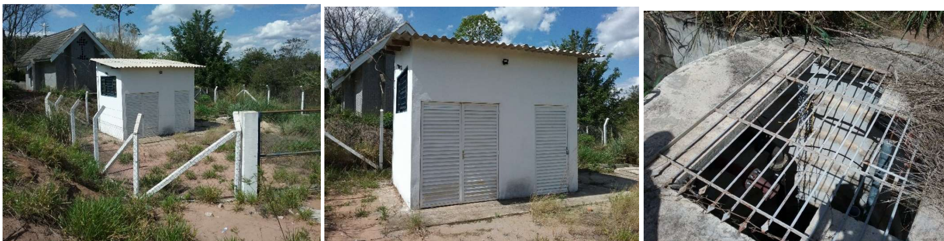
Figura 6. EEEB Bela São Pedro: construído, sem operar; recalcará para o Coletor Nova São Pedro (a executar).
