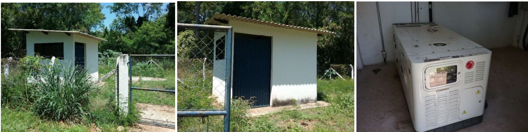
Figura 5. Estação Elevatória de Esgoto (EEEB) Pinheirinho.
