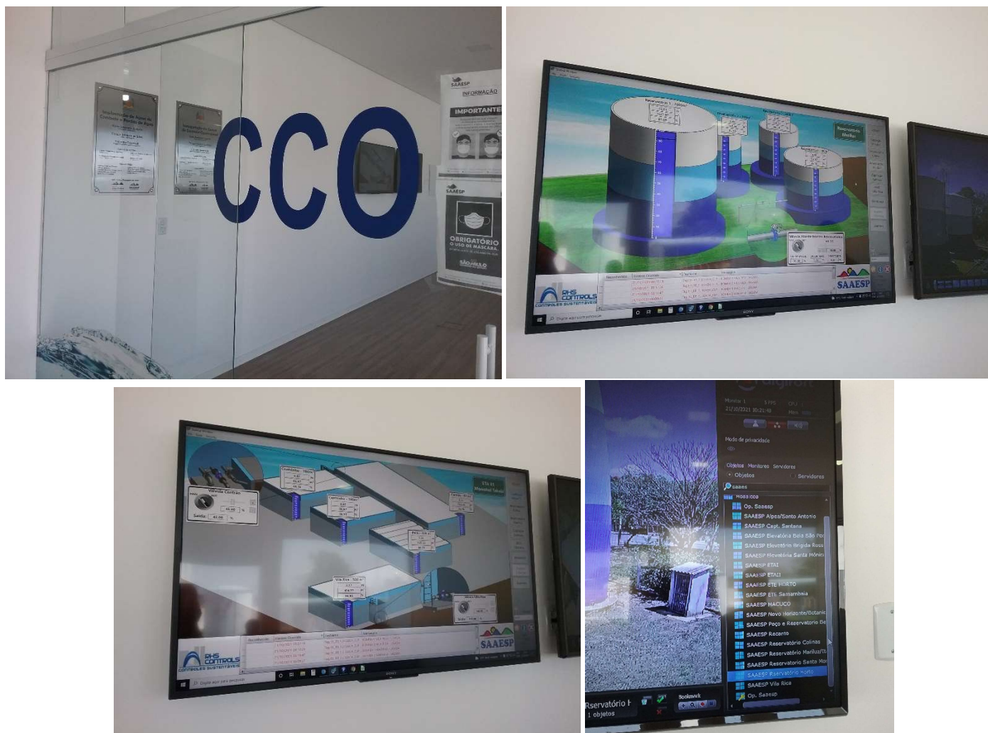
Figura 1. Centro de Controle de Operações do SAAESP (Automação e Monitoramento).
