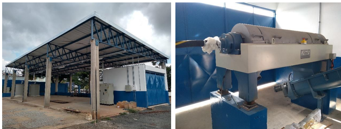
Sistema de desidratação de lodo da ETA
