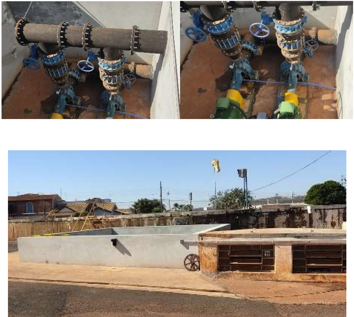
Figura TEC 1 – Booster Vila Paraiso - ETA
