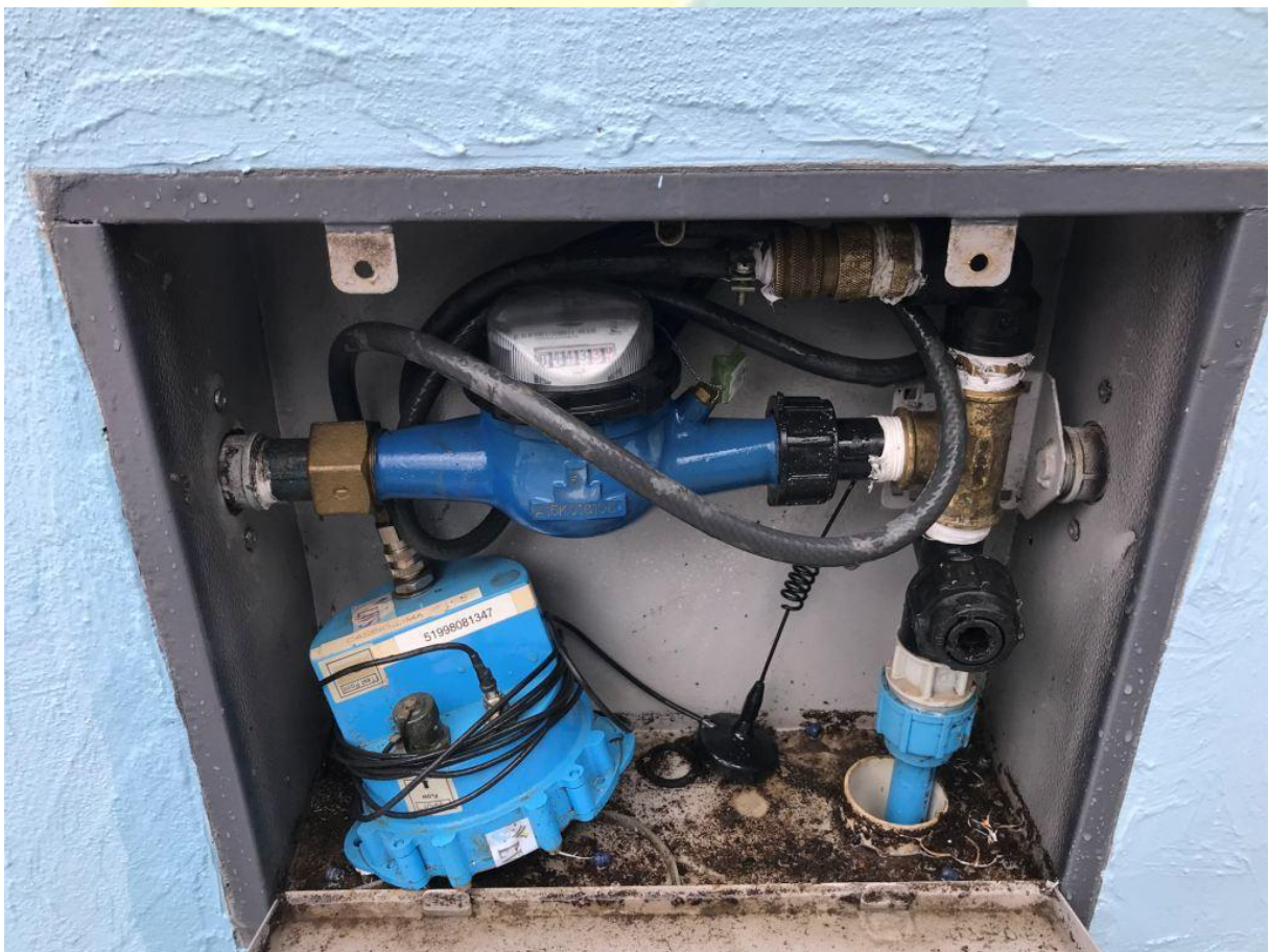
Figura 1 – Foto do local da instalação do Datalogger modelo Multilog LX GPRS
