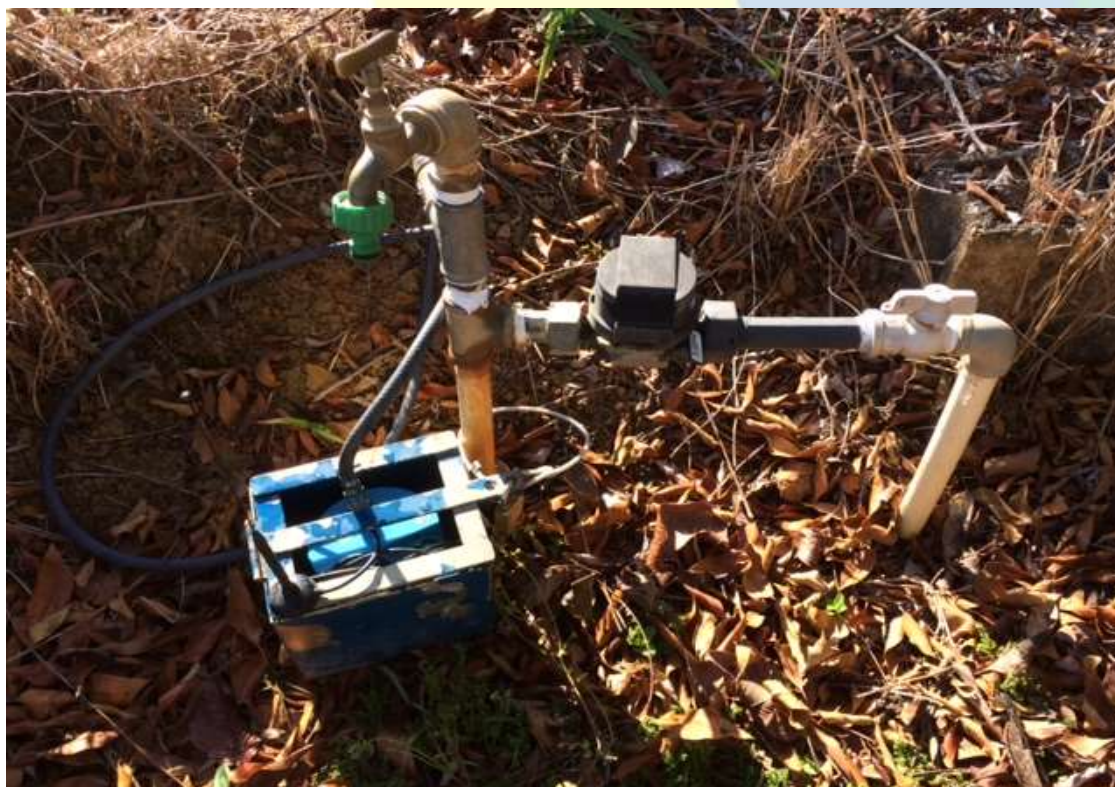
Figura 1 – Foto do local da instalação do Datalogger modelo Multilog LX GPRS
