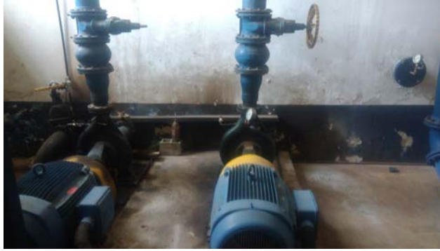
Descrição(4): Detalhe do conjunto moto-bomba
