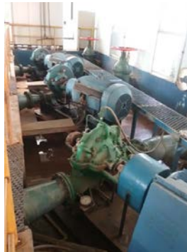
Descrição(4): conjuntos moto-bomba 1x700cv reserva, 2 x 400cv reserva
