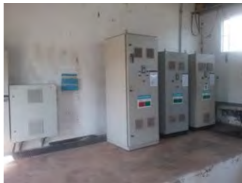
Descrição(6): Painel elétrico - Casa de bombas 1
