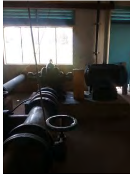
Descrição(8): Conjuntos moto bomba - Casa de bombas 2
