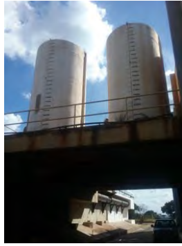
Descrição(7): Tanques de armazenamento de produtos químicos
