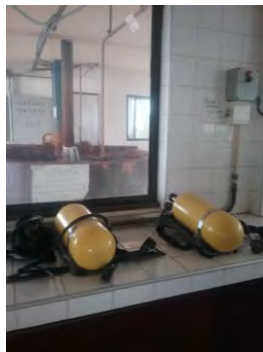
Descrição(10): Kit de emergência para vazamento de cloro gás.
