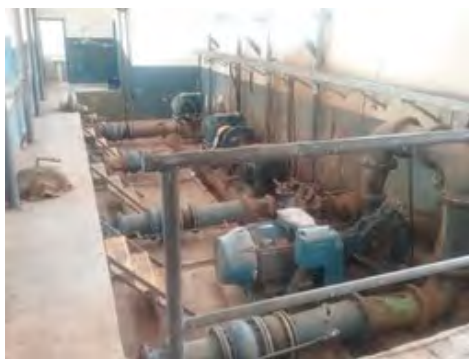
Descrição(9): Conjunto moto bomba - Casa de bombas 2
