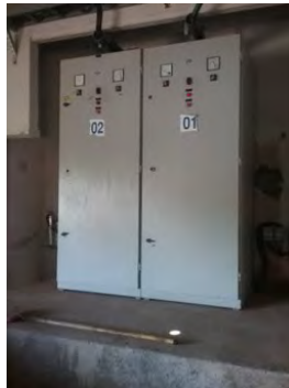
Descrição(9): Painéis elétricos - Casa de bombas 2
