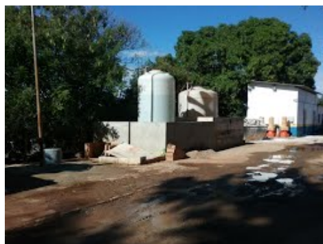
Descrição(7): Vista geral dos tanques de armazenamento com contenção
