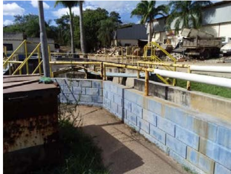
Descrição(4): Vista geral da estrutura de entrada (guarda-corpo danificado)
