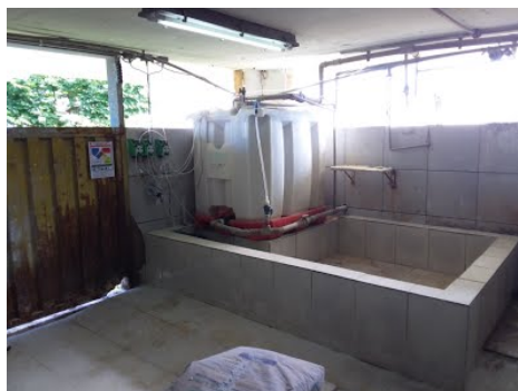
Descrição(21): Armazenamento de hipoclorito de sódio
