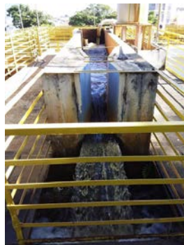
Descrição(33): Unidade de entrada do 4ª módulo
