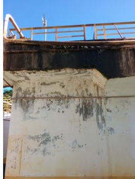
Descrição(9): Transbordamento da lâmina d'água na entrada da ETA Imagem(10)
