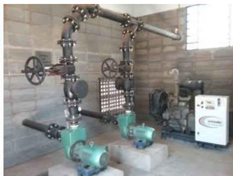
Descrição(6): Conjuntos motobomba e grupo gerador
