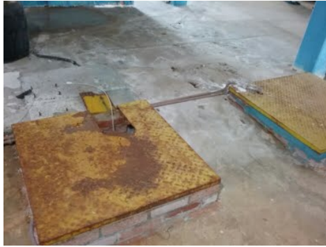
Descrição(7): Tampa do tanque de contato em más condições
