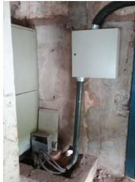
Descrição(8): Novo Painei, chave geral e cabos elétricos de alimentação da casa de bombas da captação Imagem(9)
