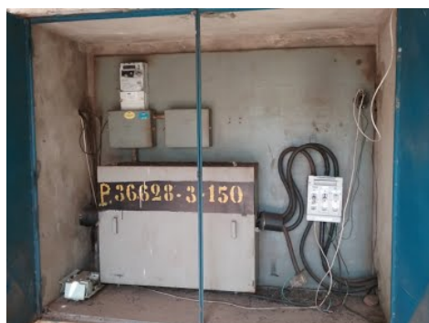
Descrição(6): Painel geral de entrada de energia elétrica com a nova chave geral e novos cabos elétricos
