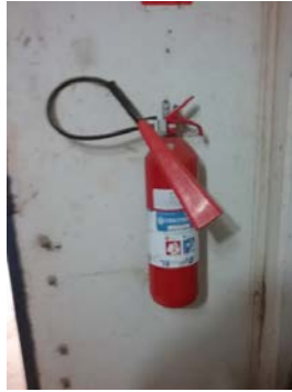
Descrição(3): Extintor de incêndio na sala dos Painéis Elétricos
