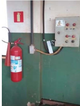
Descrição(8): Extintor de incêndio e novo painel elétrico de alguns equipamentos
