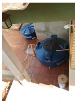
Descrição(6): Caixa com a solução de cloro para a dosagem na ETA I e ETA II, situadas no mesmo local
