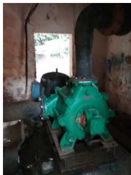
Descrição(6): Vista de um dos conjuntos moto-bombas da captação de água bruta
