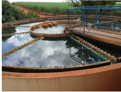
Descrição(7): Outra vista geral do módulo floculador-decantador
