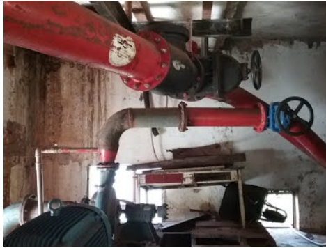
Descrição(7): Detalhe do barrilete de recalque da captação superficial do Barramento Bom Jesus I Imagem(8)
