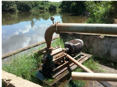
Descrição(4): Outro ângulo de visão do conjunto moto-bomba Imagem(5)
