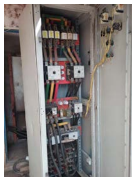
Descrição(5): Vista do interior do novo painel e novos cabos elétricos de comando do conjunto moto-bomba da captação Imagem(6)
