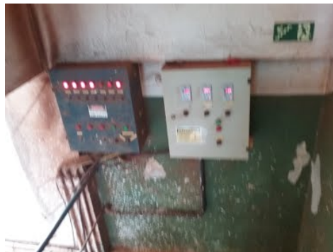
Descrição(9): Outros novos painéis elétricos de comando das bombas dosadores de produtos químicos
