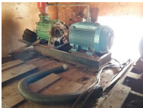
Descrição(10): Outra vista do conjunto moto-bomba da captação
