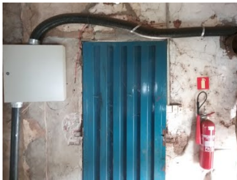
Descrição(9): Detalhe do extintor de incêndio dentro da casa de bombas Imagem(10)
