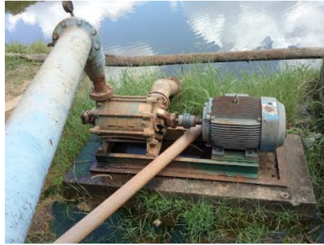
Descrição(3): Conjunto moto-bomba da Captação superficial com sucção aspirada Imagem(4)
