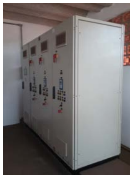
Descrição(11): Painel de comando e controle das bombas submersas
