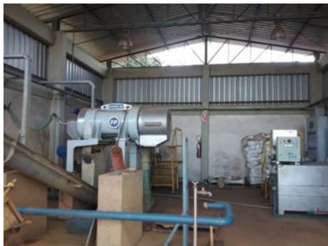
Descrição(15): Tratamento do lodo (centrifuga)
