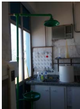
Descrição(6): Chuveiro de emergência e lava olhos
