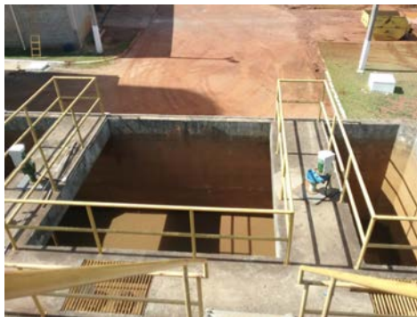
Descrição(14): Tratamento de lodo (Adensador)
