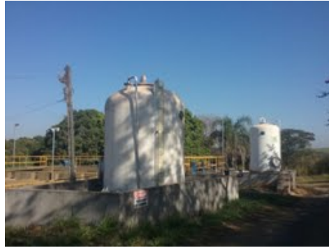
Descrição(3): Tanque de armazenamento PAC e hipoclorito de sódio, com sistema de contenção Imagem(4)
