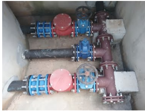
Descrição(3): Barrilete da tubulação de recalque da EEE bruto
