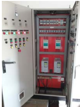
Descrição(4): Interior de um painel elétrico de comando dos conjuntos motobombas da Elevatória de Esgoto Bruto com Softstarter
