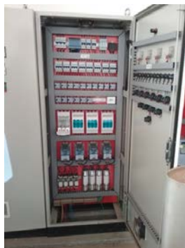
Descrição(5): Painel elétrico de entrada da energia elétrica trifásica
