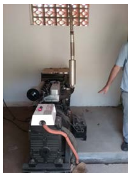
Descrição(6): Gerador de Energia Elétrica à diesel, para o funcionamento em caso de falta de energia elétrica da rede pública da CPFL
