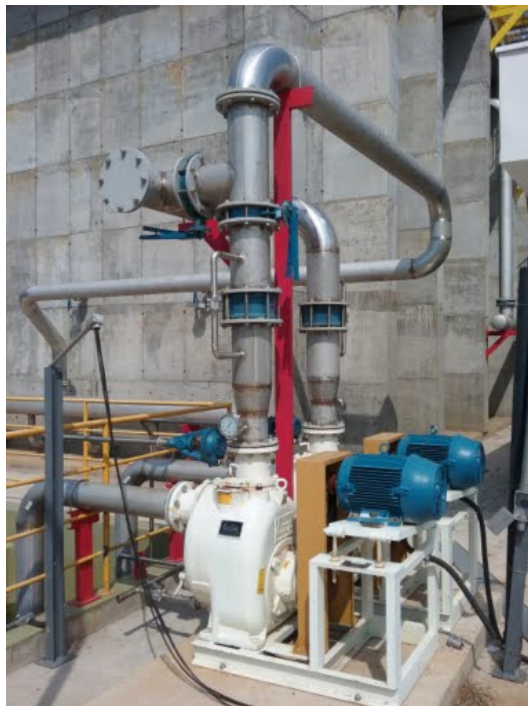
Descrição(7): Detalhe da elevatória de esgoto preliminarmente tratado.
