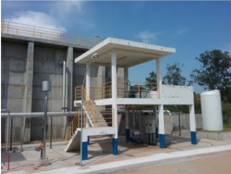
Descrição(11): Outra vista geral do 1º Módulo de Tratamento de Esgoto.
