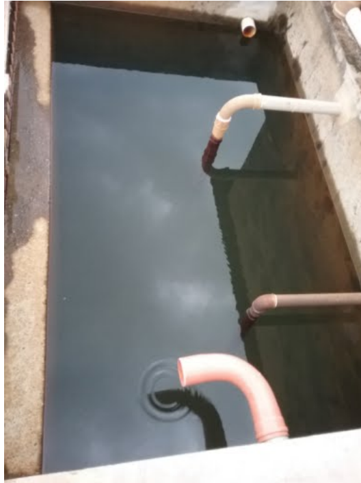
Descrição(8): Caixa de sucção da água parcialmente tratada, na caixa de sucção da elevatória local
