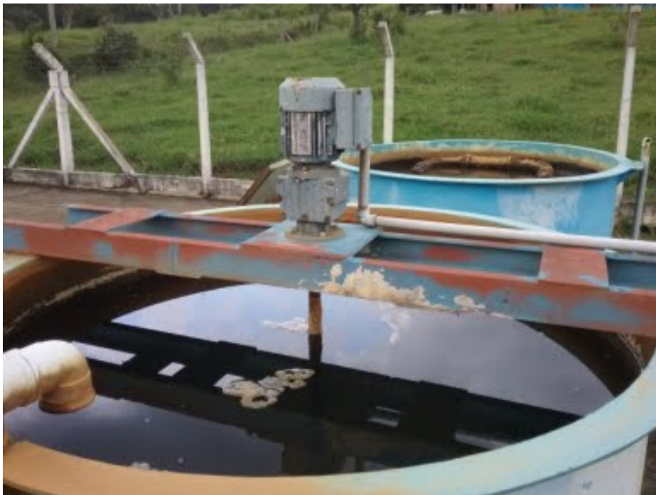
Descrição(11): Detalhe do floculador com agitação mecanizada
