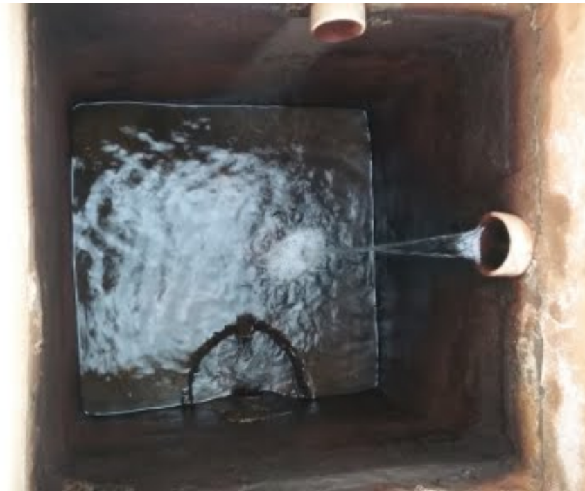
Descrição(9): Caixa de inspeção e de passagem da água vinda de uma nascente alternativa de abastecimento, cuja vazão máxima ou média são muito baixas e não atendem as necessidades das demandas do bairro.
