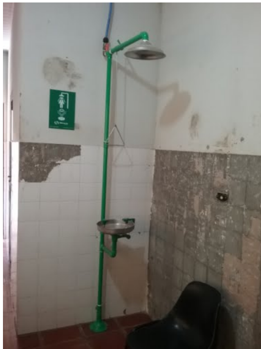
Descrição(10): Chuveiro e lava-olhos de emergência instalado em local provisório Imagem(11)
