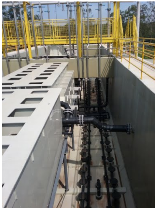
Descrição(14): Vista geral da parte superior, com detalhes do reator aeróbio de áreação prolongada, mostrando os difusores de ar comprimido
