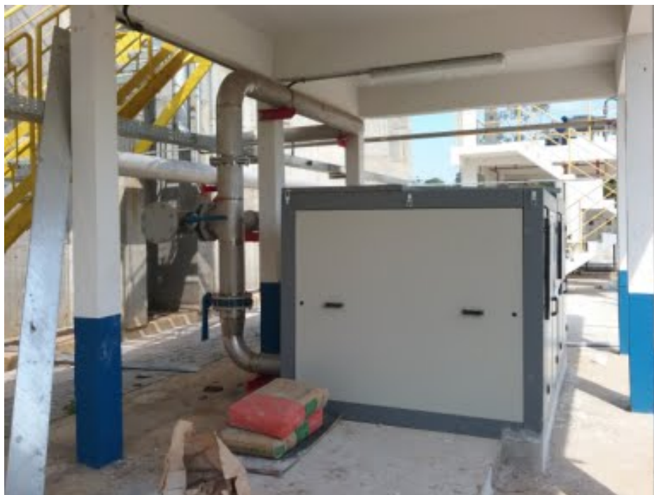
Descrição(8): Dois sopradores do sistema de aeração dos lodos ativados em abrigo coberto e sem fechamento lateral.
