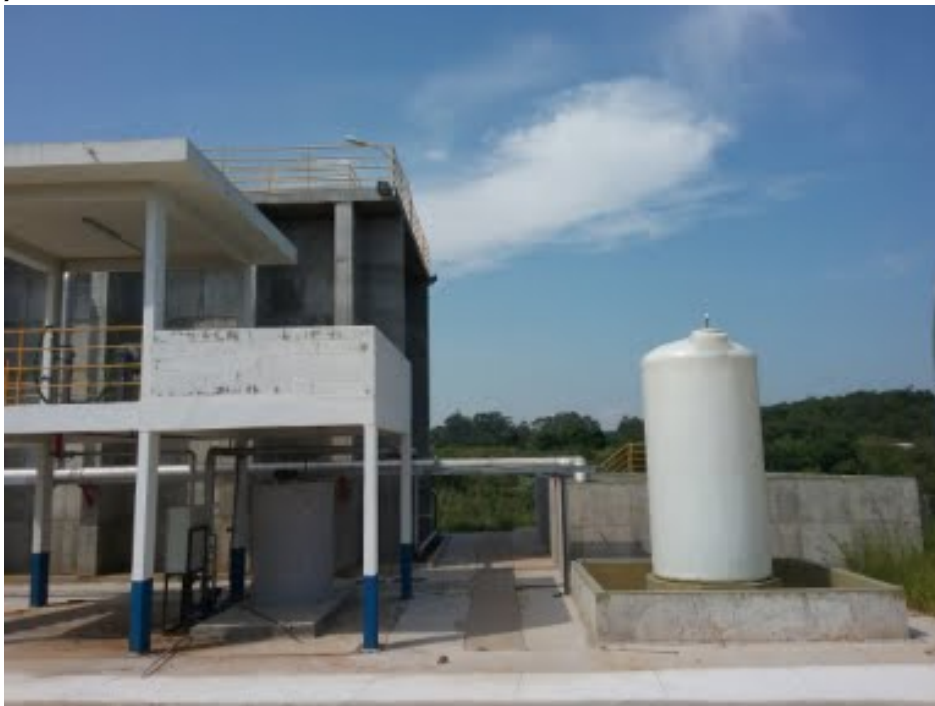
Descrição(12): Detalhe à direita na foto, do tanque de hipoclorito de sódio e, atrás, o tanque de contato para desinfecção do efluente líquido tratado, antes do lançamento pelo emissário ao corpo hídrico receptor.
