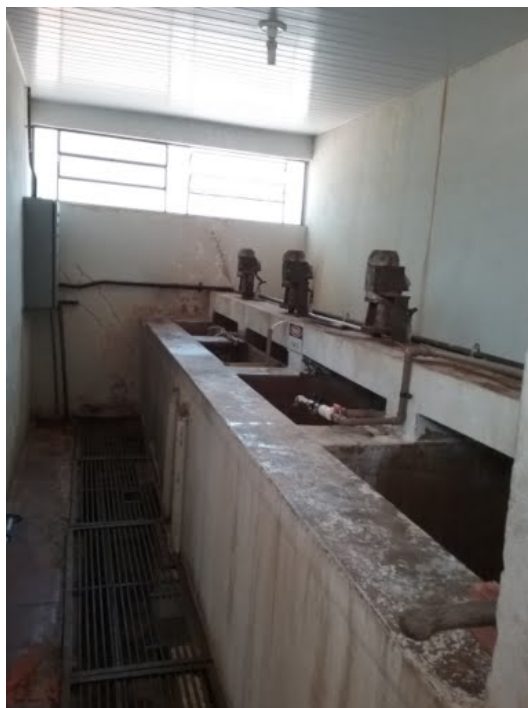
Descrição(11): Sala com tanques de preparação da solução da cal, para a dosagem no tratamento
