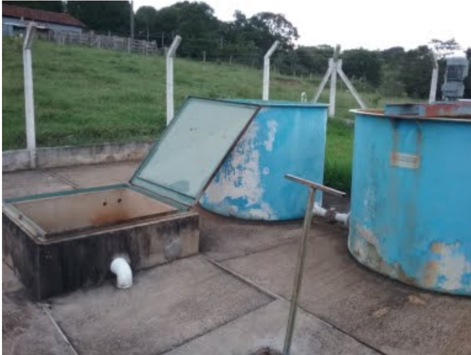
Descrição(10): Vista dos tanques do floculador mecanizado e do decantador de fluxo ascendente na sequência Imagem(11)
