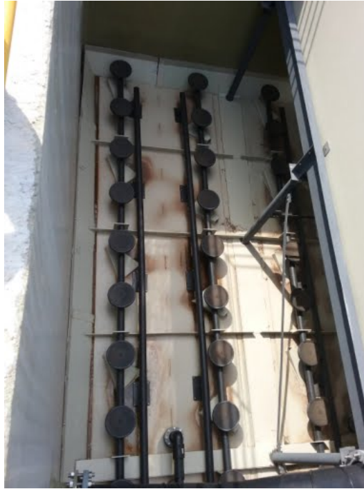
Descrição(13): Detalhe dos difusores de ar no fundo do reator aeróbio de lodos ativados sobre o UASB Imagem(14)
