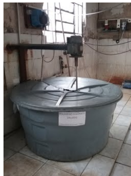
Descrição(11): Reservatório de PAC para a floculação
