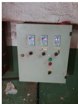
Descrição(11): Painel de controle do agitador de cal
