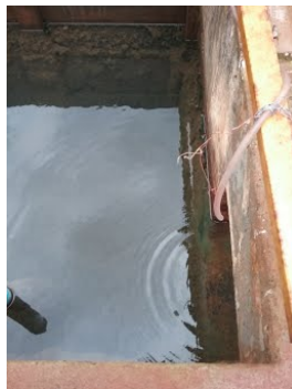
Descrição(7): Dosagem de cloro na saída do floculador
