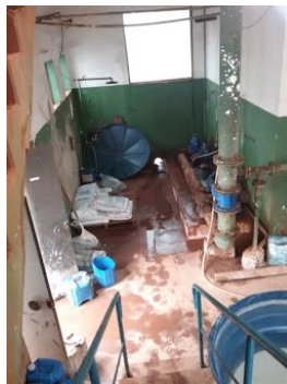
Descrição(15): Visão geral da casa de química, dosadores e armazenamento de produtos químicos
