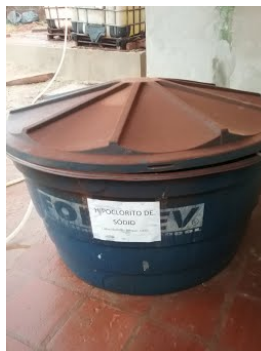
Descrição(15): Armazenamento de cloro inadequado
