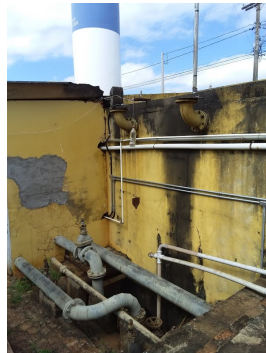
Descrição(4): Medidor de nível não está funcionando
