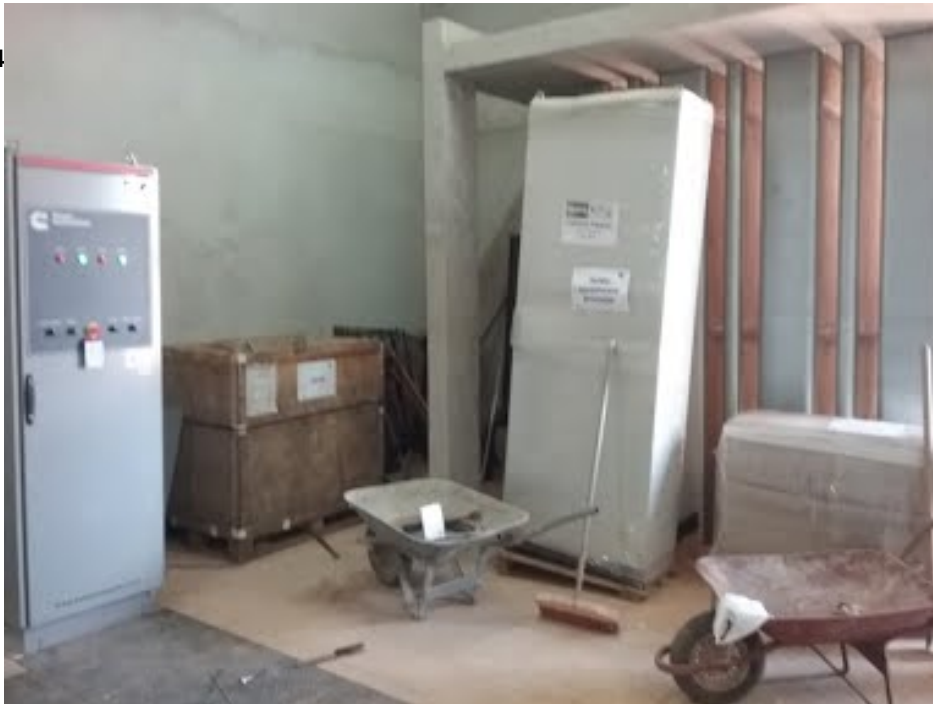
Descrição(14): Sala de painéis elétricos de comando dos diversos conjuntos motobombas
