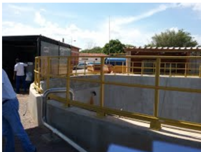
Descrição(10): Poço de reservação do lodo da ETA e módulo de desidratação do lodo
