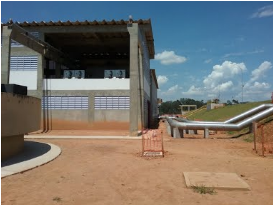
Descrição(4): Módulo que abriga os compressores sopradores e as tubulações principais para os difusores de ar nos módulos de tratamento de esgoto de lodos ativados por aeração prolongada (Investimentos na ampliação da ETE Mário Araldo Candelo)
