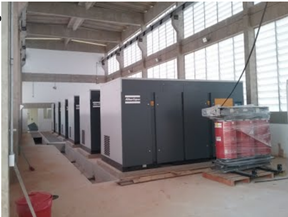
Descrição(10): Sala de compressores sopradores em implantação para atender três novos módulos de tratamento e dois existentes
