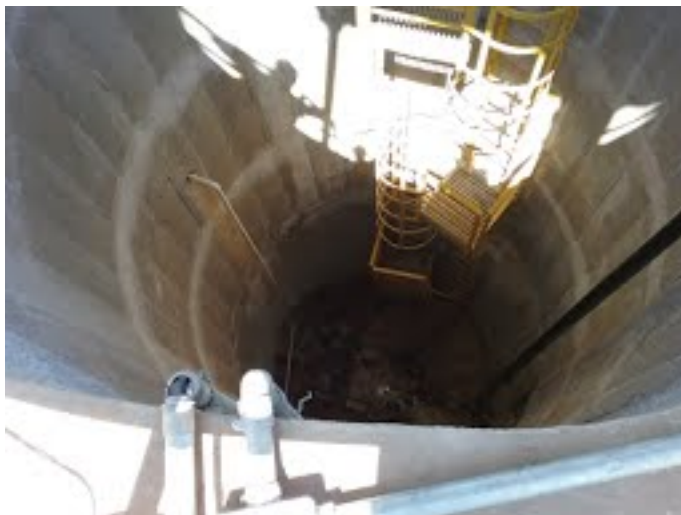
Descrição(5): Poço de sucção com conjunto motobomba que alimenta a centrífuga desidratadora do lodo
