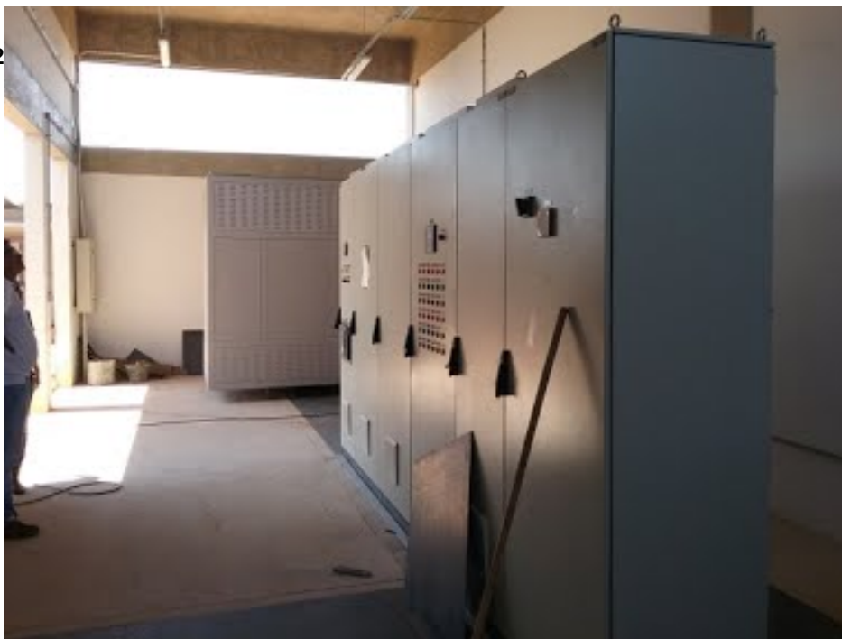
Descrição(12): Sala dos painéis elétricos de comando dos compressores- sopradores
