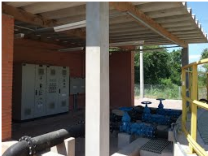
Descrição(3): Barrilete de entrada do lodo no poço de reservação do lodo descartado pela ETA III
