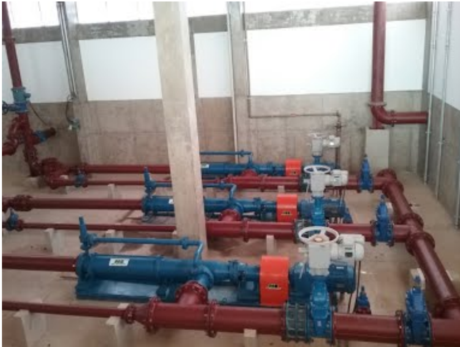
Descrição(8): Elevatória de lodos para a desidratação
