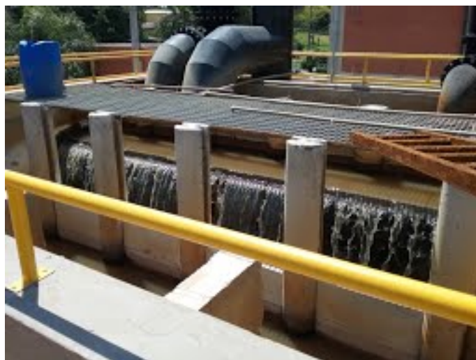
Descrição(17): Entrada da água bruta e caixa desarenadora
