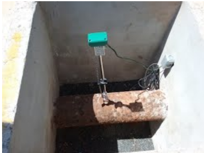
Descrição(13): Macromedidor de vazão de inserção da Captação superficial do Buruzinho
