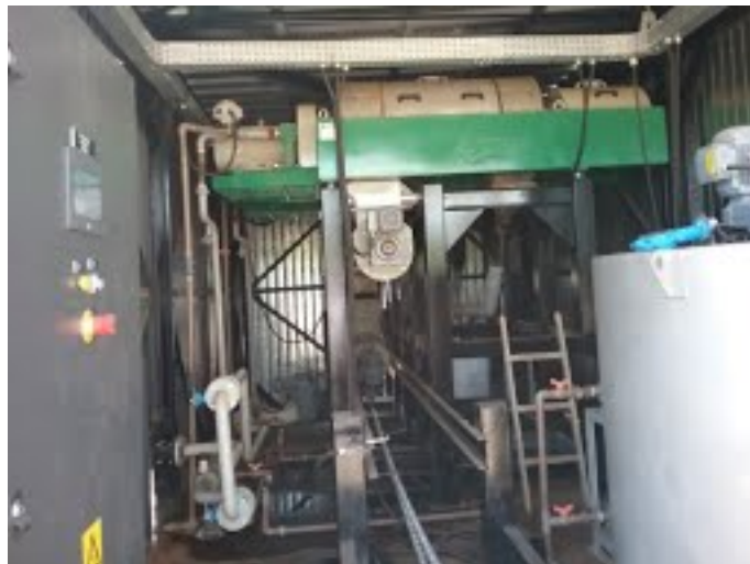
Descrição(9): Interior do módulo com o adensador e a centrífuga desaguadora do lodo da ETA III
