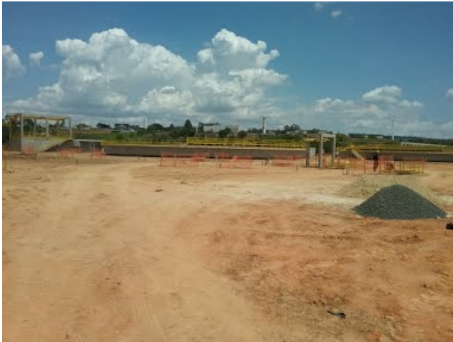
Descrição(15): Vista geral dos novos decantadores na sequência dos tanques de lodos ativados
