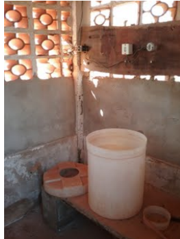
Descrição(8): Dosagem de produtos químicos está desativada - sem cloração e fluoretação
