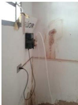
Descrição(6): Bomba dosadora de flúor - Não estava funcionando no momento da visita
