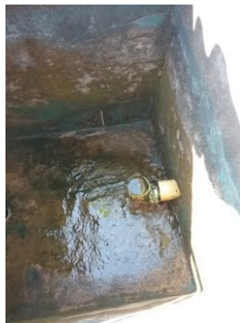
Descrição(9): Caixa de saída do tanque de solo filtrante (wetlands)
