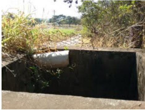
Descrição(7): Caixa de entrada da água bruta
