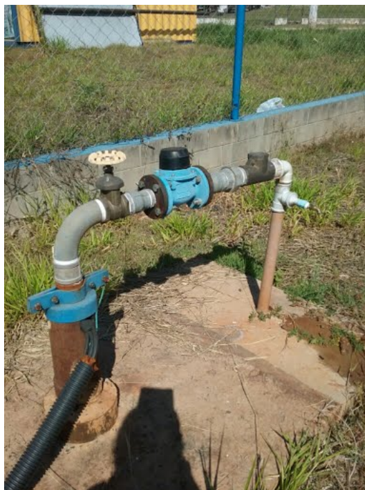
Descrição(2): Macromedidor (hidrômetro) que alimenta exclusivamente o reservatório apoiado
