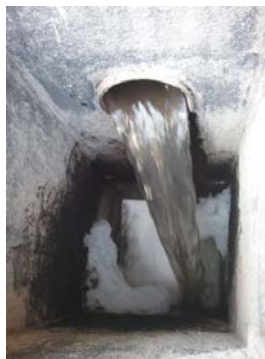
Descrição(17): Caixa de passagem do efluente tratado Imagem(18)
