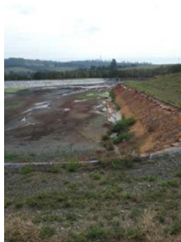
Descrição(10): Outra foto mostrando a extensão dos danos na manta de impermeabilização
