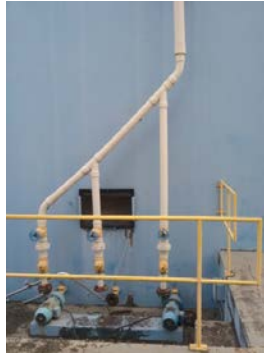
Descrição(12): Conjuntos motobombas de recirculação do esgoto, no interior do Filtro Biológico Imagem(13)
