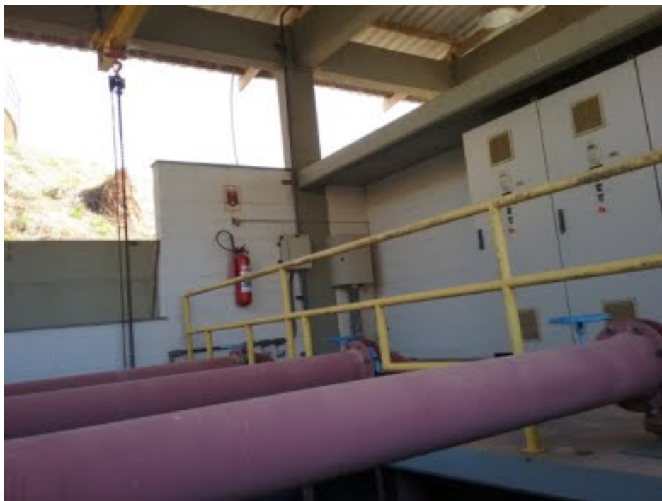
Descrição(5): Estrutura de monovia com talha para içamento dos conjuntos motobombas para a manutenção
