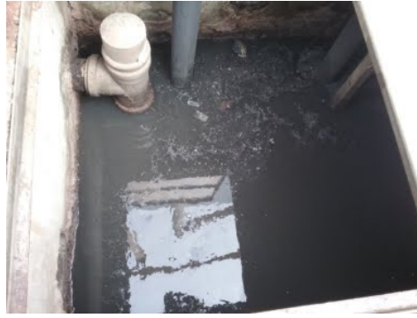
Descrição(11): Poço de sucção do esgoto, recalque para o Filtro Biológico Imagem(12)
