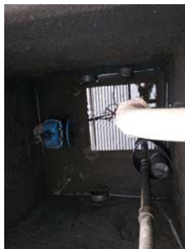
Descrição(14): Caixa de inspeção ao lado do decantador
