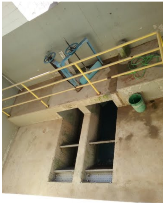
Descrição(2): Comporta e gradeamento do esgoto bruto antes do poço de sucção para recalque Imagem(3)
