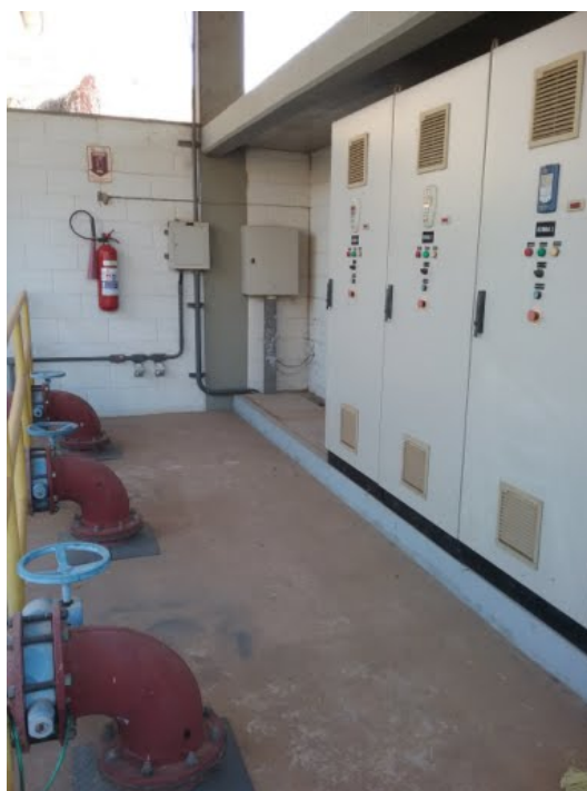
Descrição(3): Painel elétrico de comando dos conjuntos motobombas da EEEB e ao fundo o extintor de incêndio
