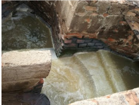
Descrição(8): Caixa de passagem do esgoto bruto que vai por gravidade para ser tratado na ETE Rio Sorocaba e não é tratado nesta ETE Aliança
