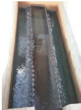
Descrição(4): Vertedor do filtro de areia que promove uma filtração mais bem distribuída por área
