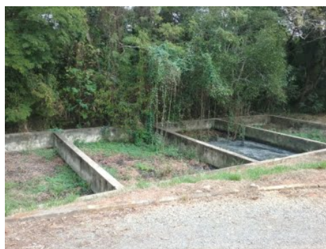
Descrição(18): Leito de secagem do lodo de esgoto
