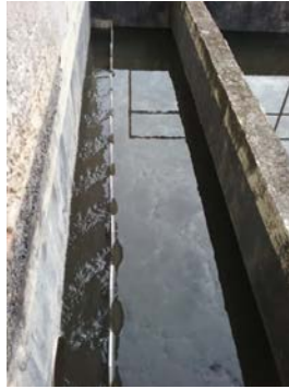
Descrição(16): Calha do vertedor do decantador e direcionamento para caixa de passagem e lançamento do efluente tratado em corpo hídrico local Imagem(17)
