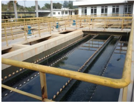
Descrição(3): Vista de outro módulo do Decantador de alta taxa de decantação
