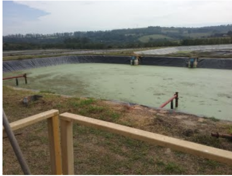
Descrição(7): Vista da 1ª sequência do Conjunto de Lagoa Anaeróbia e Lagoa Facultativa
