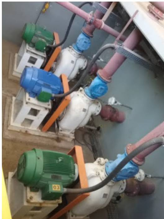
Descrição(4): Conjuntos motobombas da Elevatório de Esgoto Bruto da ETE Capuava
