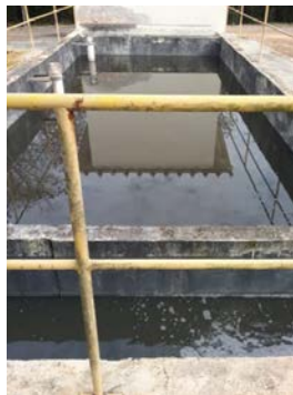
Descrição(13): Decantador em operação, após a passagem pelo Filtro Biológico Imagem(14)
