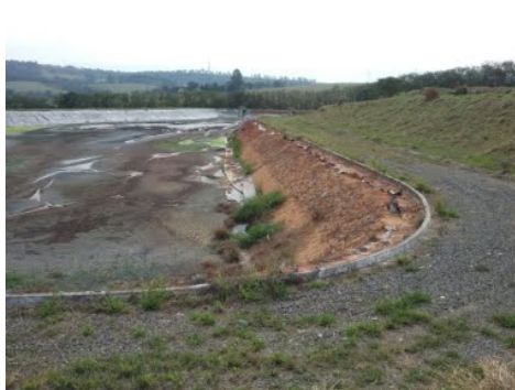
Descrição(9): Detalhe de uma das lagoas facultativas, cuja manta de impermeabilização foi danificada em um incêndio e encontra-se paralisada a operação de tratamento para a realização da limpeza e reparos de recuperação da manta
