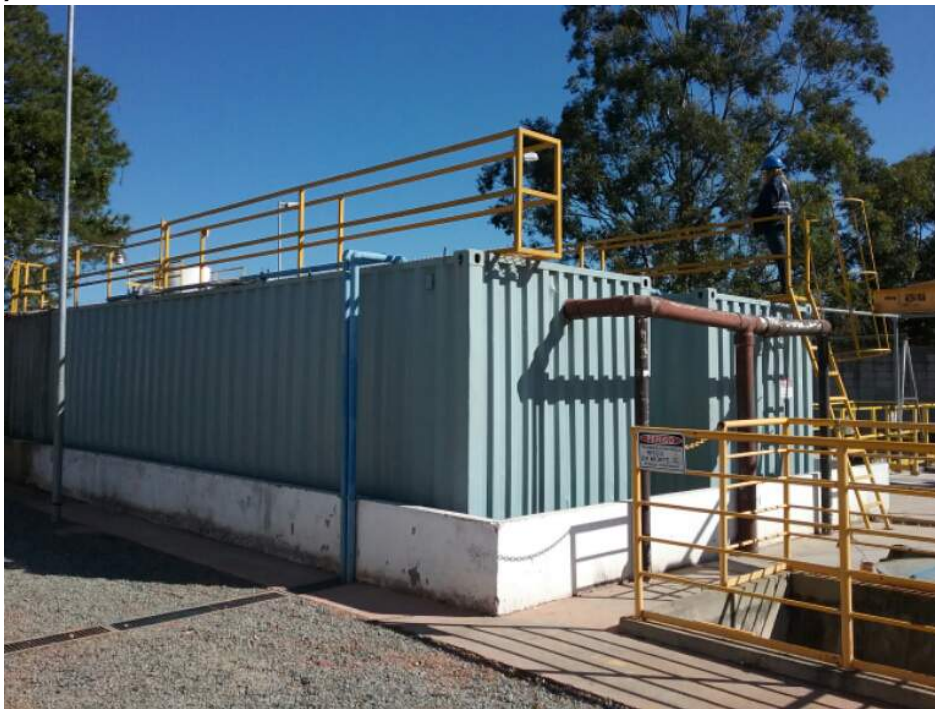
Descrição(16): Sistema híbrido de biomassa aderida e em suspensão (Moving Bed Bio Reactor - MBBR)
