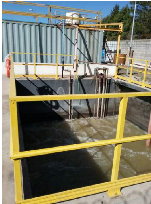
Descrição(10): Tanque de aeração após tratamento preliminar e anterior ao reator de leito móvel
