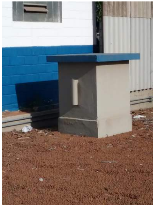
Descrição(4): Detalhe de tubulação de ventilação sem tela de proteção contra entrada de animais
