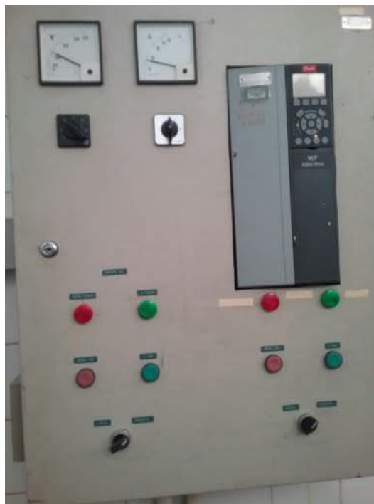
Descrição(5): Paine de comando e operação
