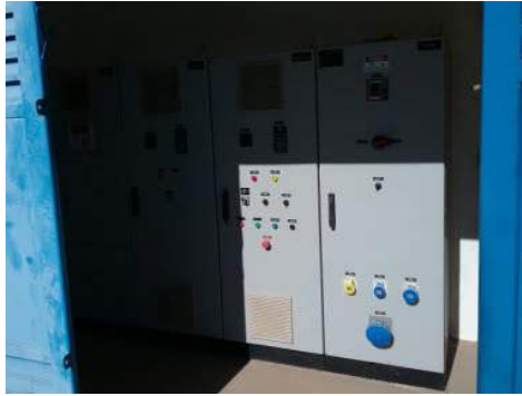
Descrição(3): Painel de comando e operação
