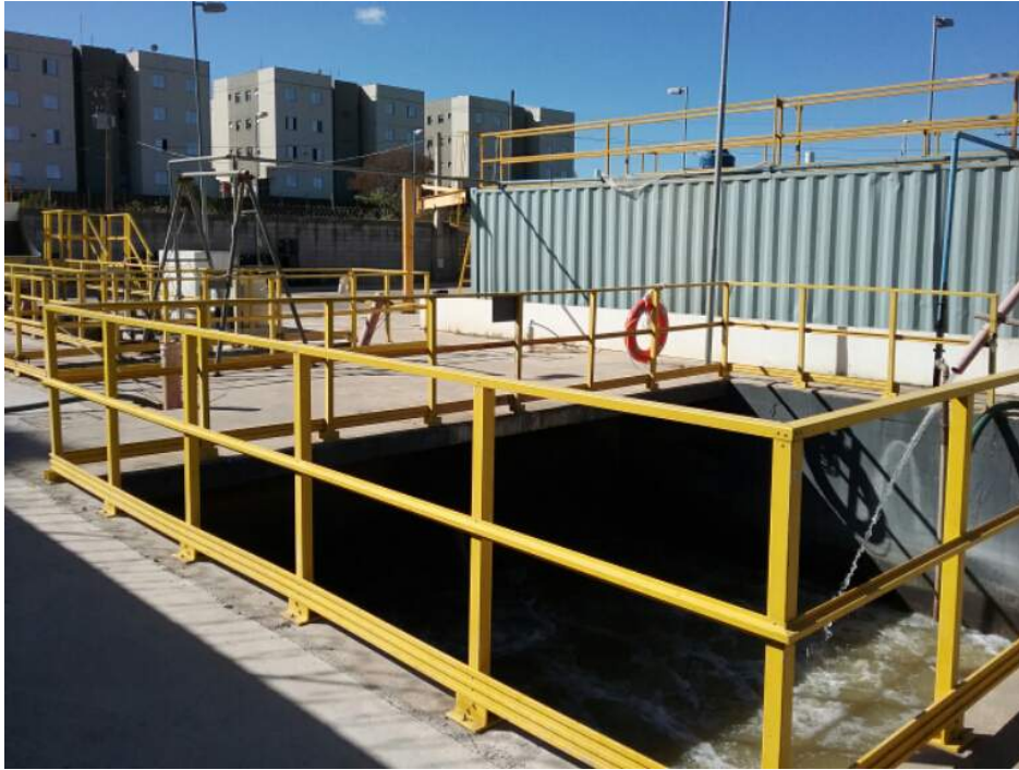
Descrição(11): Vista geral do tanque de aeração e dos módulos dos reatores de leito móvel ao fundo Imagem(12)
