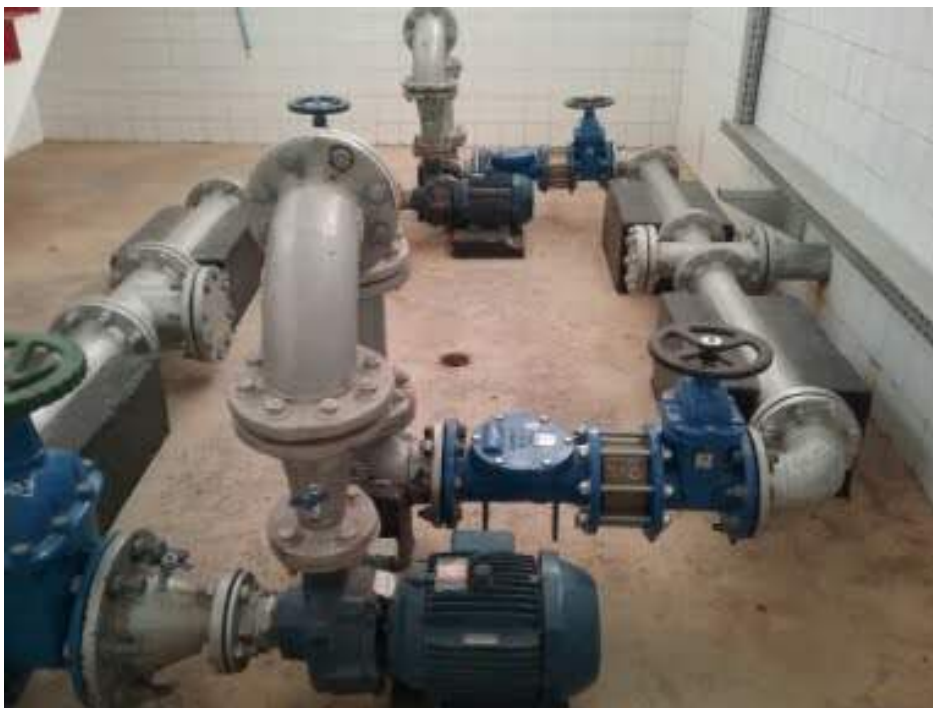
Descrição(3): Conjuntos motobomba
