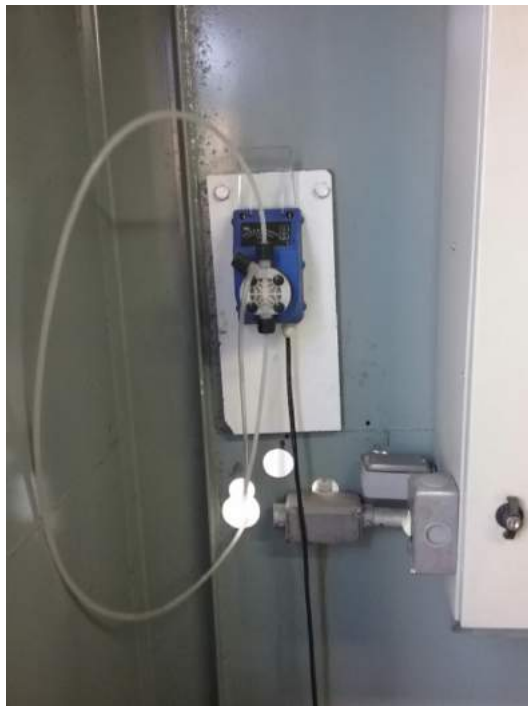
Descrição(6): Bomba dosadora de produto anti-espumante no módulo do biofiltro
