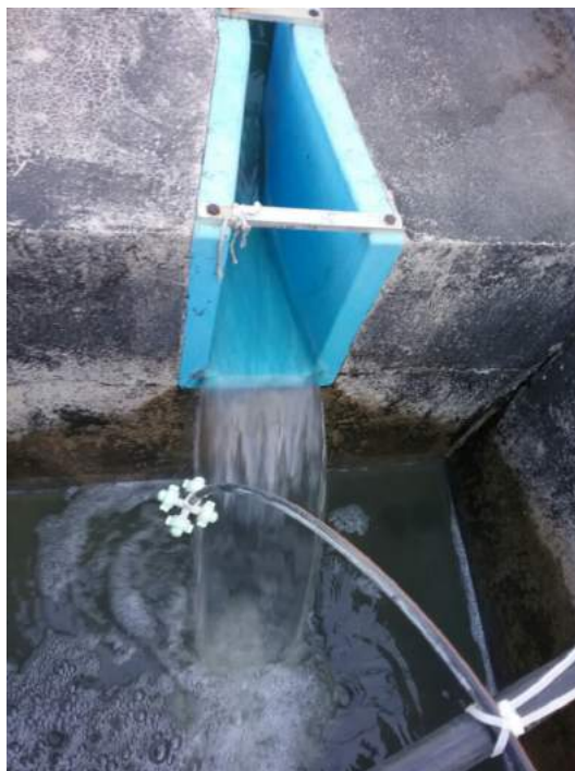
Descrição(7): Calha Parshall de saída do efluente tratado com um aspersor de desodorizante
