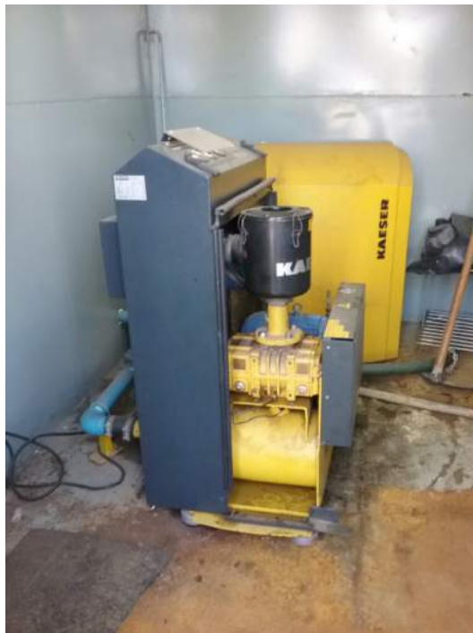
Descrição(4): Soprador para alimentar o módulo do biofiltro aeróbio
