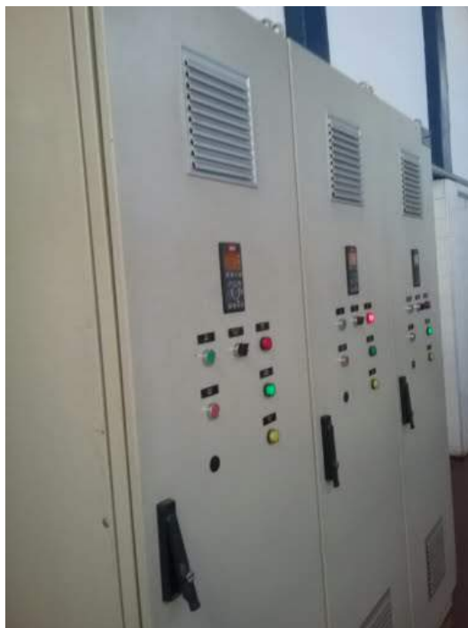
Descrição(3): Painel de comando e operação
