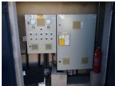
Descrição(6): Detalhe do extintor de incêndio e do painel elétrico
