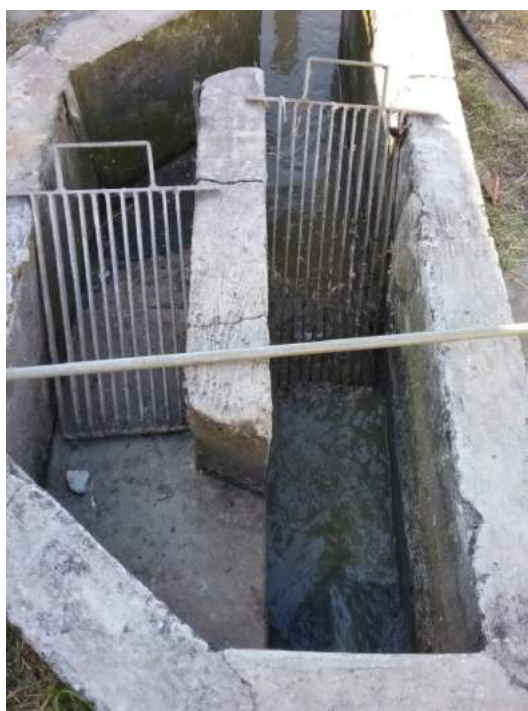
Descrição(4): Detalhe do gradeamento grosseiro
