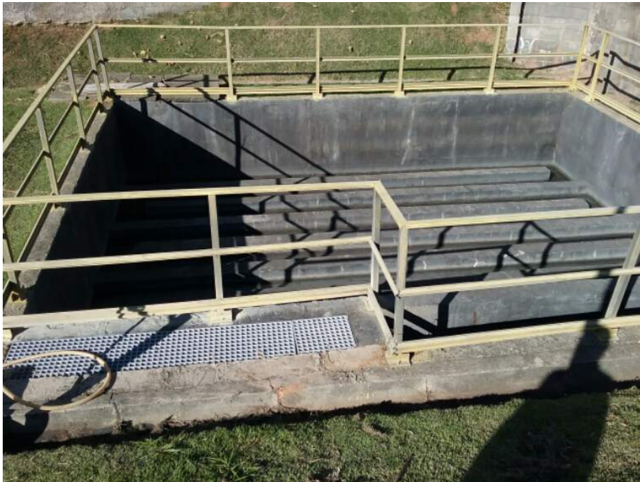
Descrição(3): Tanque de contato para desinfecção do efluente com hipoclorito de sódio
