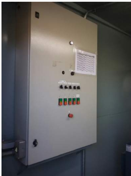
Descrição(5): Painel elétrico de comando dos conjuntos motobombas submersas da elevatória de esgoto bruto
