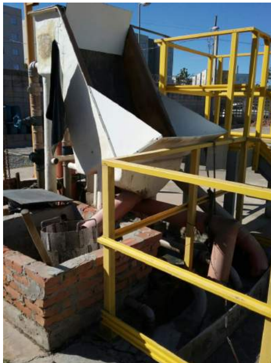
Descrição(5): Outra vista do gradeamento e desarenador
