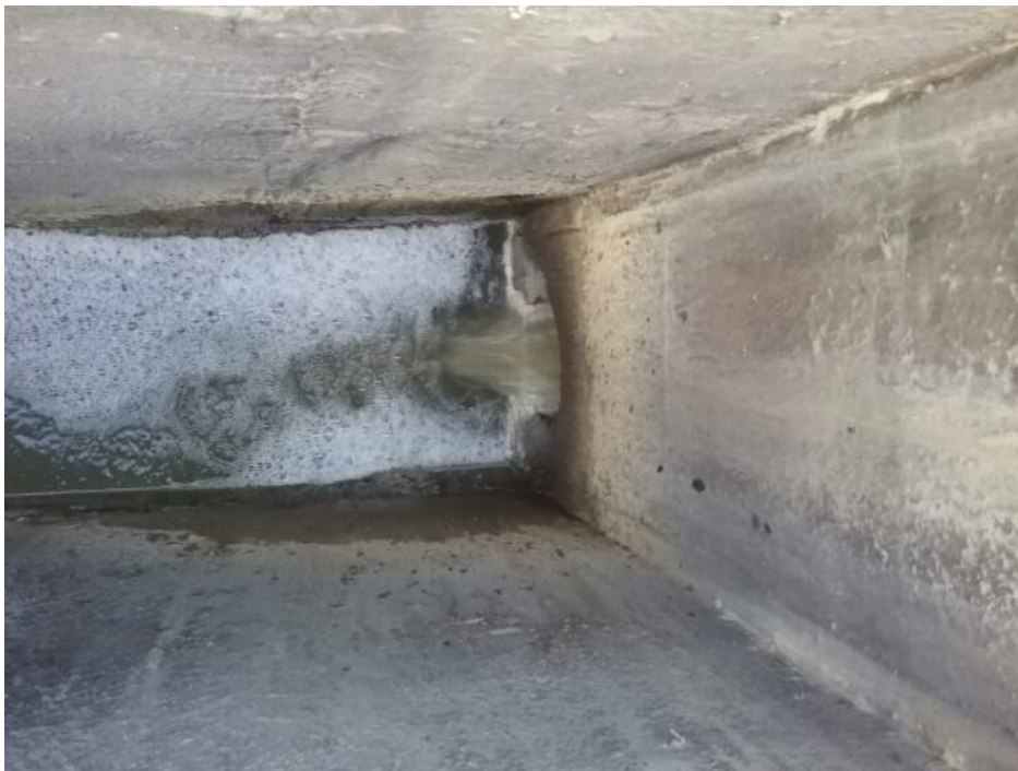
Descrição(4): Saída do efluente tratado
