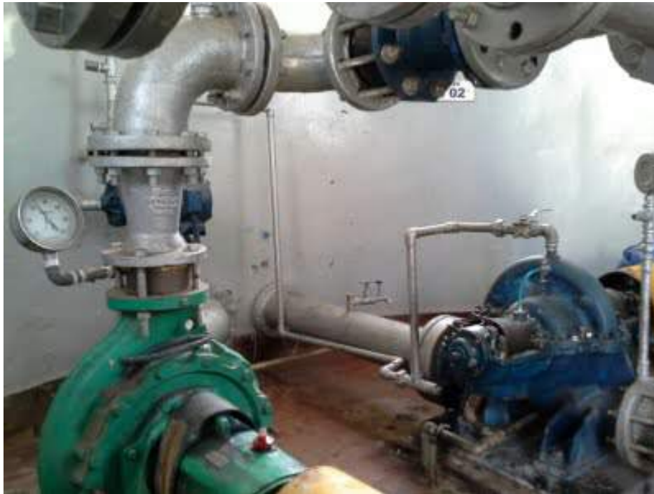
Descrição(2): Manômetro na tubulação de um dos conjuntos motobomba
