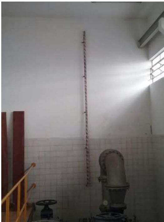
Descrição(5): Medidor de nível do reservatório
