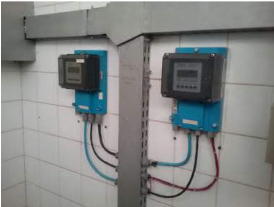
Descrição(6): Painei da medição de vazão
