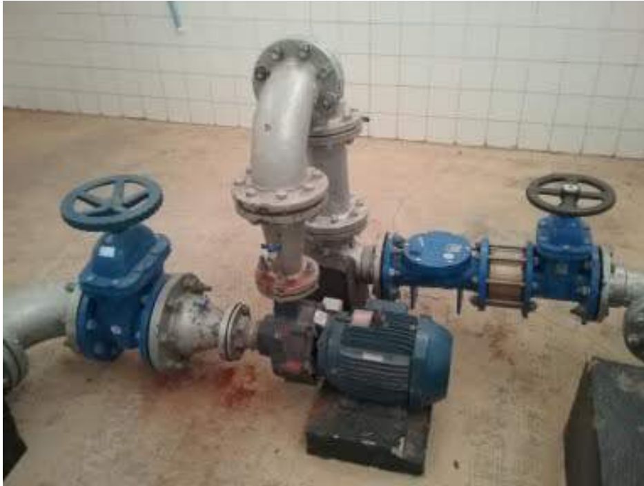
Descrição(4): Detalhe da válvula de retenção
