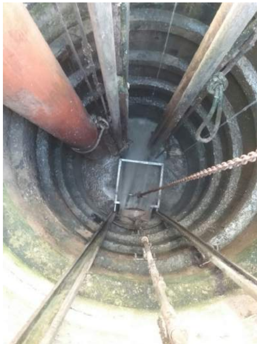
Descrição(3): Poço de entrada do esgoto bruto com cesto de gradeamento
