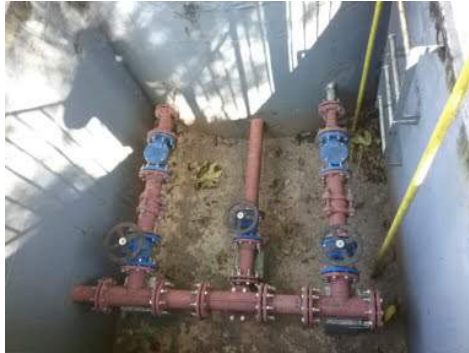
Descrição(4): Detalhe das válvulas de retenção
