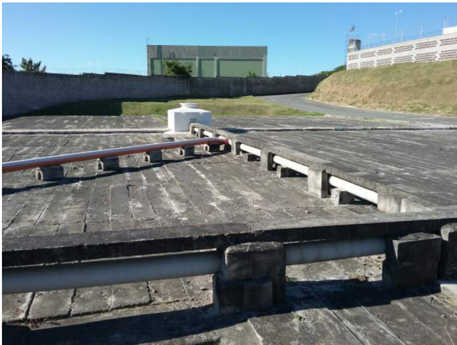
Descrição(8): Detalhe das tubulações que interligam os módulos dos tanques sépticos à caixa de distribuição nos filtros aeróbios
