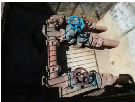
Descrição(6): Detalhe das válvulas de retenção
