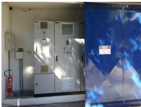
Descrição(6): Painel de comando e operação
