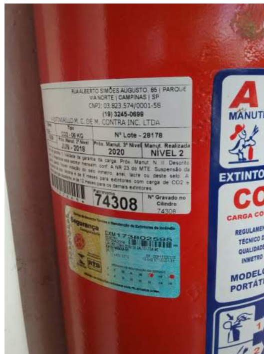
Descrição(2): Detalhe da validade do extintor
