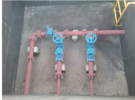
Descrição(4): Detalhe das válvulas de retenção
