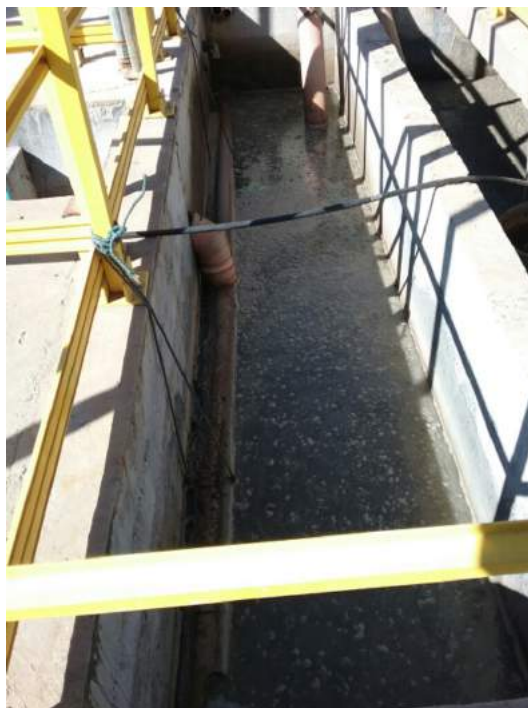
Descrição(8): Tanque de contato de desinfecção do efluente tratado
