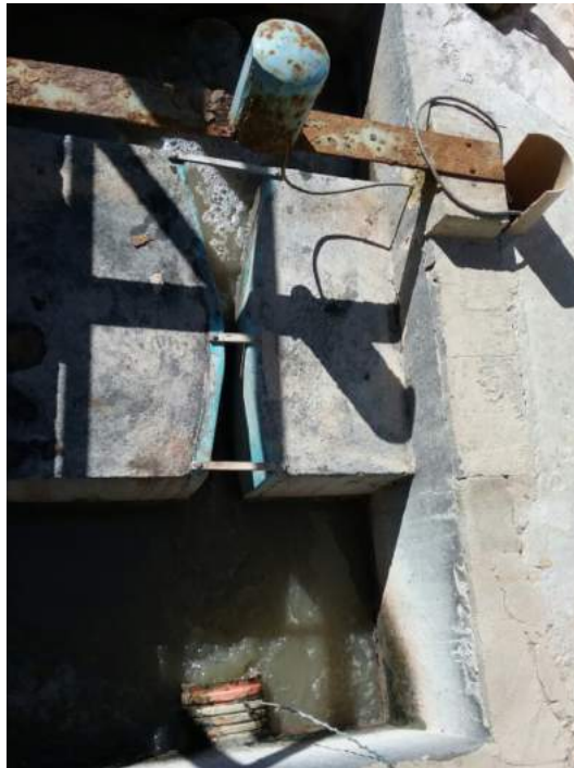
Descrição(7): Calha Parshall de entrada do esgoto
