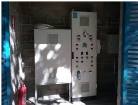
Descrição(5): Painel de comando e operação e extintor de incêndio
