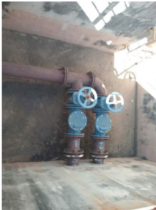
Descrição(12): Detalhe das válvulas de retenção na tubulação de recalque da elevatória de esgoto
