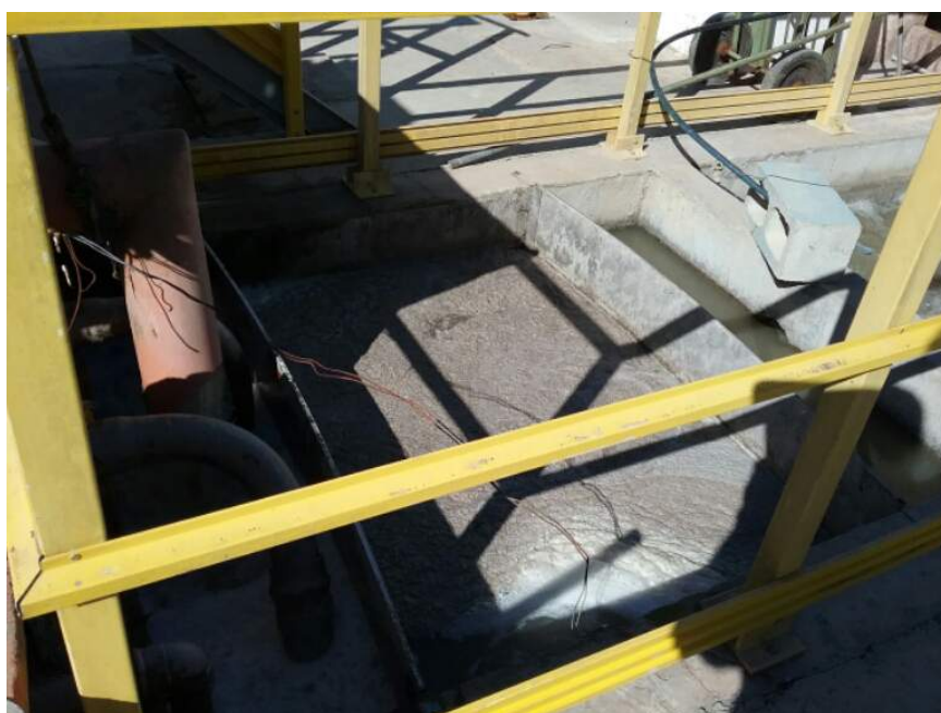
Descrição(6): Caixa de gordura
