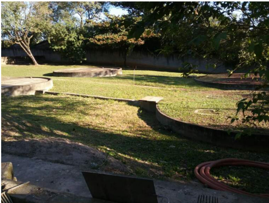
Descrição(3): Destaque dos tanques sépticos seguidos de filtros anaeróbios
