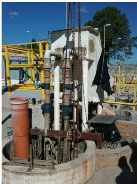
Descrição(4): Desarenador e grade que recebem o esgoto bruto da elevatória
