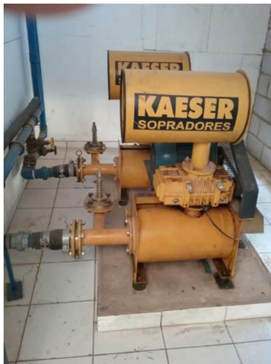
Descrição(18): Conjuntos de compressores-sopradores de ar
