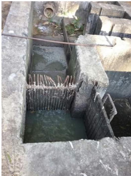
Descrição(4): Caixa de distribuição com gradeamento
