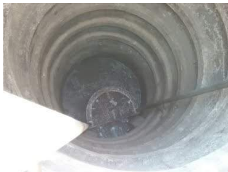
Descrição(5): Detalhe da válvula de retenção Imagem(6)
