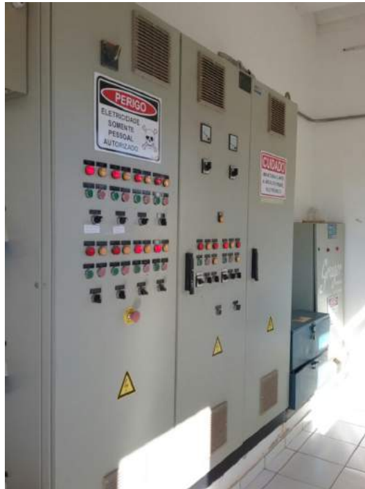
Descrição(17): Painéis de comando elétrico dos conjuntos motobombas Imagem(18)
