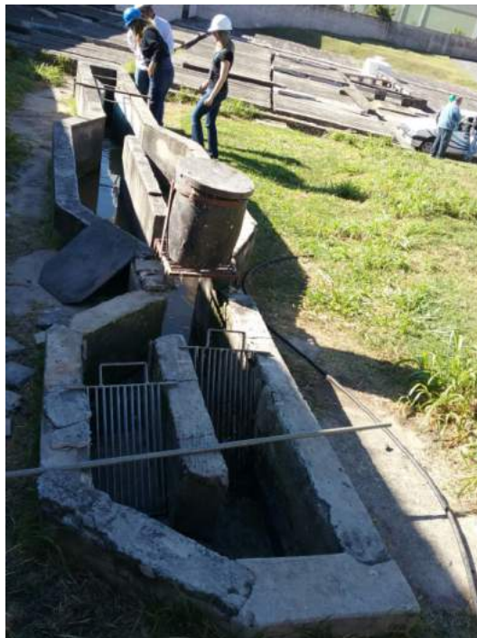
Descrição(3): Tratamento preliminar com gradeamento grosseiro, desarenador e calha Parshall
