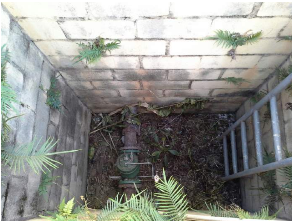
Descrição(3): Detalhe do macromedidor
