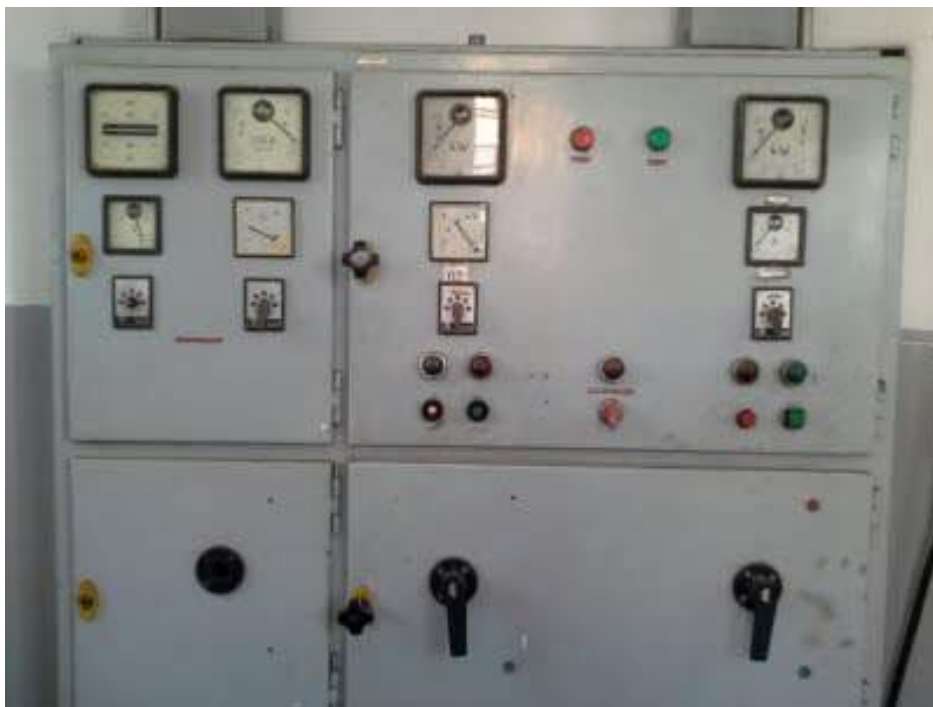
Descrição(3): Painel elétrico
