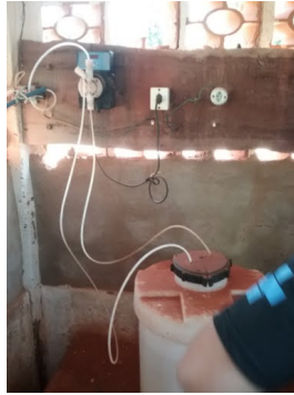
Descrição(8): Cloração da água que passa pela Wetland
