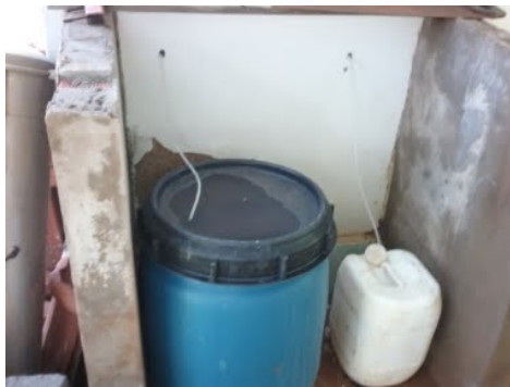
Descrição(4): Armazenamento de cloro e flúor
