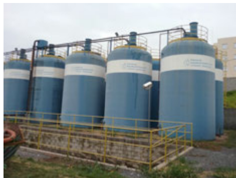
Descrição(10): Vista geral das etapas do processo de tratamento da ETE Estâncias
