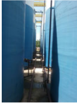
Descrição(10): Barrilete da tubulação de interligação entre os Reatores UASB com os Filtros Biológicos Imagem(11)
