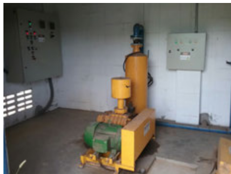
Descrição(13): Sopradores de ar comprimido
