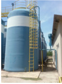
Descrição(6): Baterias de Reatores UASB de fluxo ascendente e Filtros Biológicos na sequência Imagem(7)
