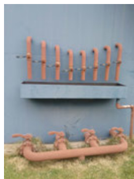
Descrição(12): Barrilete de tubulação do Reator UASB
