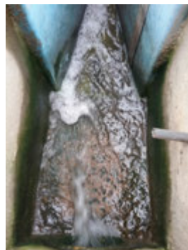
Descrição(12): Calha Parshall no lançamento do efluente tratado
