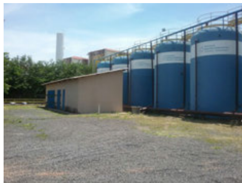
Descrição(17): Casa de sopradores e abrigo dos painéis elétricos e extintores
