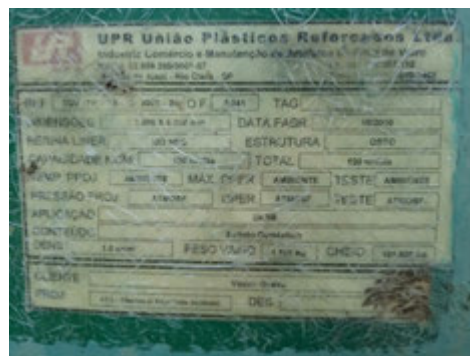
Descrição(8): Placa de identificação de um dos Reatores UASB com algumas características e especificações de projeto
