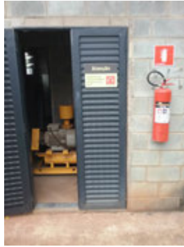
Descrição(13): Sala de sopradores e extintor de incêndio
