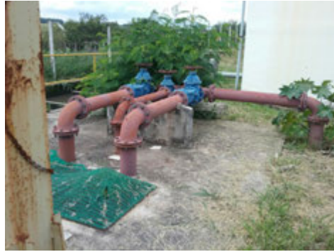
Descrição(10): EEE de lançamento do efluente tratado no emissário do Bordon II
