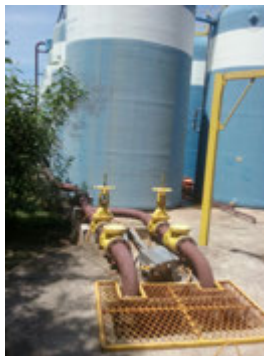
Descrição(8): EEE - Bruto após o tratamento preliminar que recalca o esgoto para os Reatores UASB. Imagem(9)
