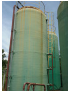
Descrição(7): Detalhes de algumas tubulações de interligação entre os diversos equipamentos
