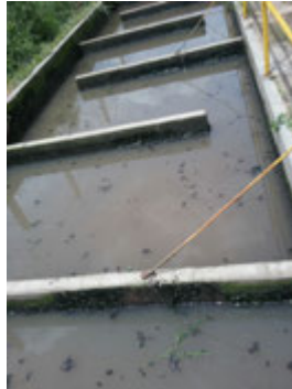
Descrição(7): Tanque de contato com o efluente tratado final com muito sólido em suspensão que são retidos por uma tela na saída do tanque e retirados com frequência
