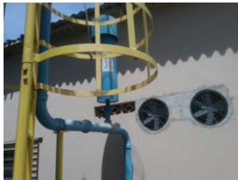
Descrição(12): Detalhes da escada uma escada de acesso à cobertura do Reator UASB com guarda corpos e da tubulação de ar comprimido que sai dos sopradores e alimentação os Filtros aeróbicos.
