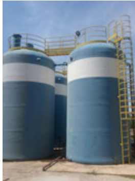
Descrição(7): Vista geral dos Reatores UASB e Filtros Biológicos perfilados Imagem(8)
