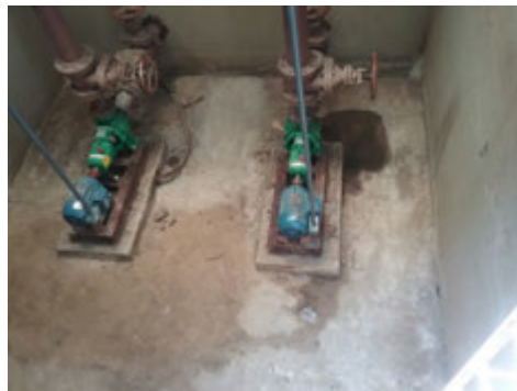
Descrição(5): Conjuntos moto-bombas na casa de bombas subterrânea Imagem(6)
