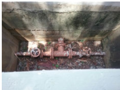
Descrição(6): Barrilete de recalque do esgoto bruto com registros de manobras de vazões
