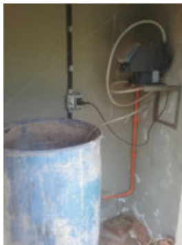
Descrição(9): Dosador de polímeros desativado, lodo retirado por caminhão limpa-fossa
