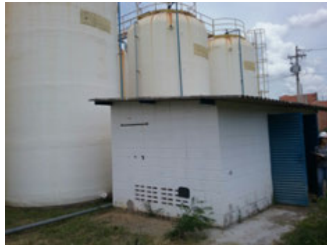
Descrição(11): Casa dos sopradores ao lado dos tanques de tratamento de esgoto
