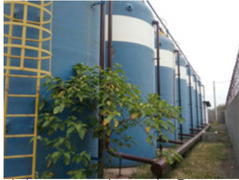
Descrição(7): Detalhe da escadaria acesso a cobertura dos Reatores e Filtros com guarda-corpos
