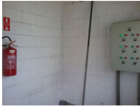
Descrição(6): Painel elétrico e extintor de incêndio
