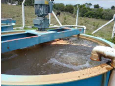
Descrição(2): Detalhe da tubulação da entrada da água bruta e formação de flocos
