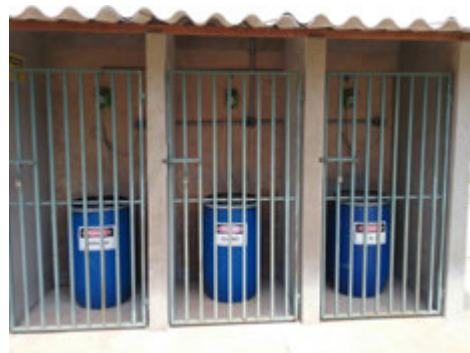
Descrição(11): Misturas e bombas dosadoras de barrilha, cloro e PAC Imagem(12)
