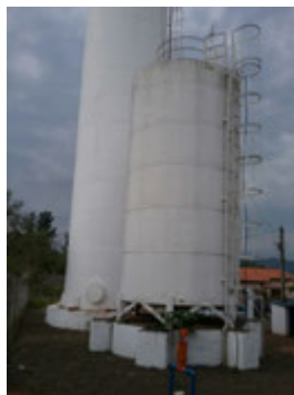
Descrição(7): Vista geral dos dois reservatórios
