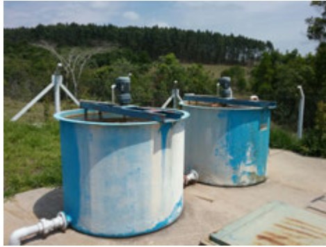
Descrição(1): Mistura rápida e floculadores mecanizados
