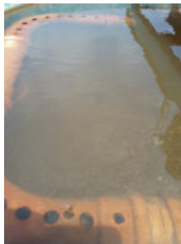
Descrição(3): Detalhe do tubo vertedouro de saída de um dos floculadores mecanizados
