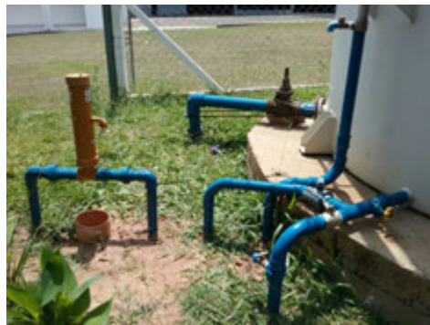
Descrição(6): Barriletes das tubulações na base do Reservatório Imagem(7)
