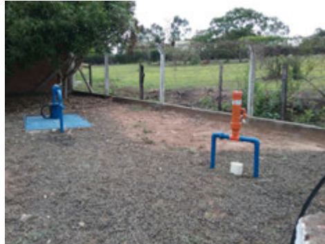
Descrição(5): Poço e dosadora de cloro com pastilhas que abastece o Reservatório
