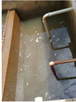
Descrição(9): Poço de sucção da água tratada, mas não filtrada, pela EEAT ao lado Imagem(10)
