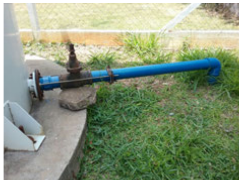
Descrição(7): Tubulação de saída para a distribuição
