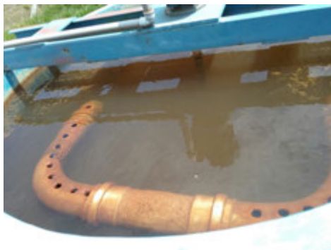
Descrição(4): Outra vista do interior e superfície de um floculador
