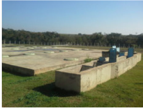
Descrição(4): Vista geral da ETE Anhumas com o tratamento preliminar e tanque séptico anaeróbio
