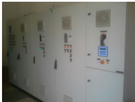
Descrição(14): Conjuntos de painéis de Comandos Elétricos dos conjuntos motobombas
