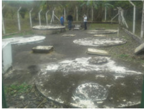
Descrição(2): Vista geral da ETE Fossa - filtro anaeróbio - poços sumidouros
