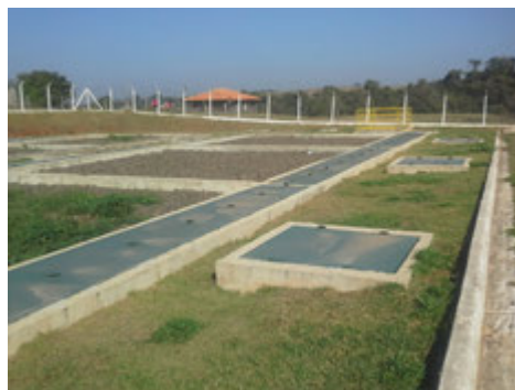
Descrição(7): Detalhe da fase do filtro anaeróbio
