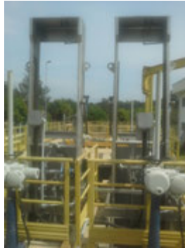
Descrição(7): Detalhes dos equipamentos das grades mecanizadas
