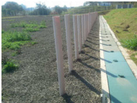
Descrição(11): Filtro de britas, última fase do tratamento
