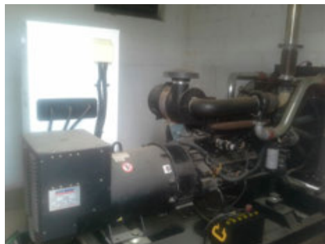
Descrição(18): Gerador de energia elétrica à diesel
