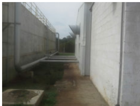
Descrição(17): Barrilete de recalque e alimentação de ar comprimido saindo da sala dos sopradores para os tanques de lodos ativados com aeração prolongada
