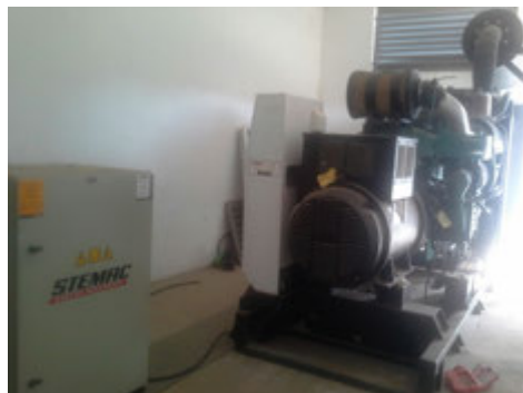
Descrição(10): Sala do gerador de energia elétrica com painel de comando elétrico
