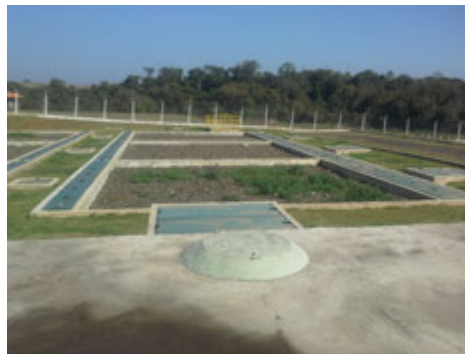
Descrição(6): Detalhe de um dos módulos da fase de tratamento pelo filtro anaeróbio após o tanque séptico
