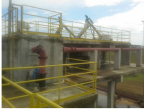
Descrição(15): Vista geral do tratamento preliminar
