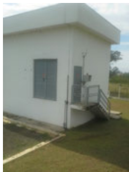
Descrição(9): Edificação da cabine de entrada de energia elétrica com transformador de alta tensão
