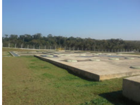
Descrição(5): Tanque séptico anaeróbio seguido de filtro de britas
