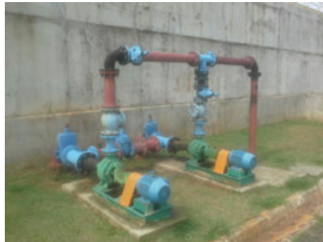
Descrição(16): Conjuntos motobombas da recirculação de lodos
