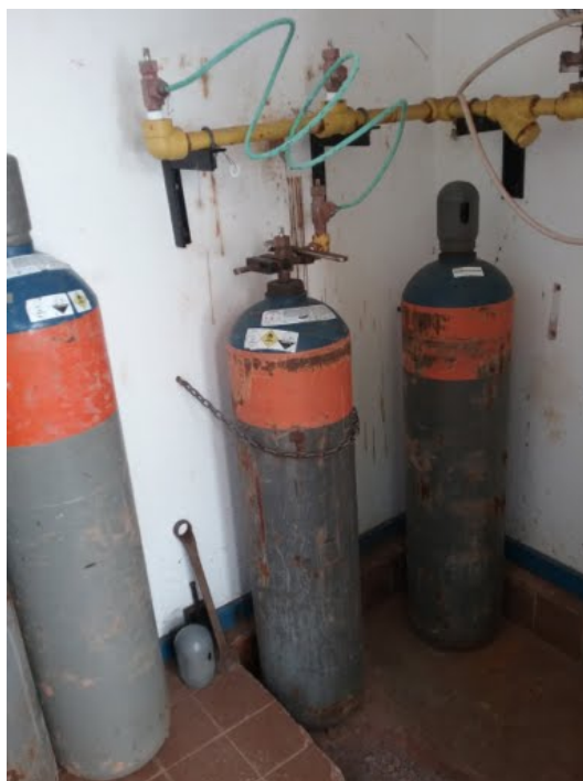
Descrição(3): Cilindros de cloro armazenados (à esquerda) e em uso (à direita). Há um desnível que dificulta a troca dos cilindros, que é realizada manualmente.
