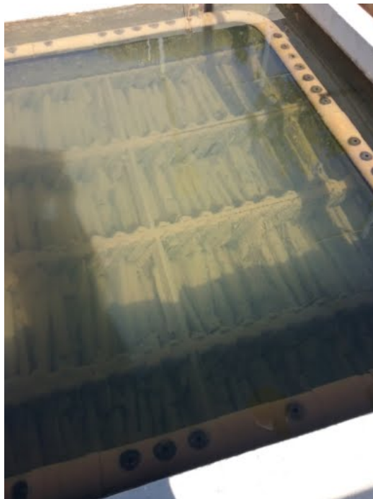
Descrição(6): Sistema de decantação por lonas
