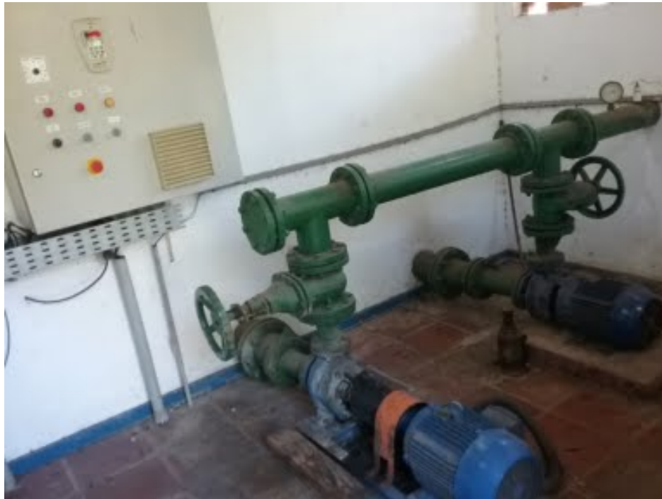
Descrição(8): Conjuntos motobombas de recalque para o Sistema Caixa Alta
