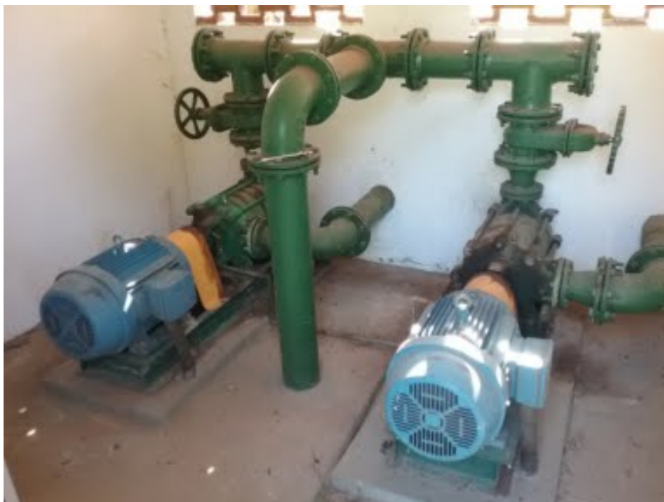
Descrição(7): Conjuntos motobombas que recalcam para o bairro Ponte Preta e, futuramente, para Orypaba
