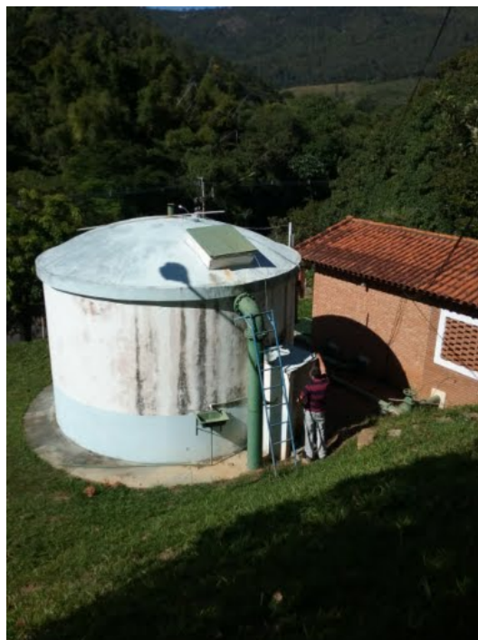
Descrição(5): Faltam guarda-corpos no reservatório
