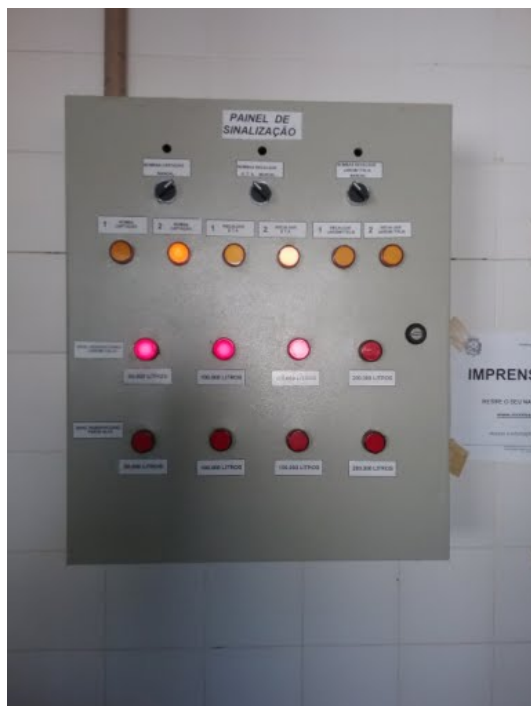
Descrição(2): Painel elétrico (inclusive para a captação)
