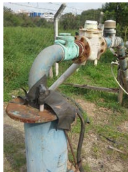
Descrição(7): Vista aproximada da boca do poço tubular profundo e cavalete
