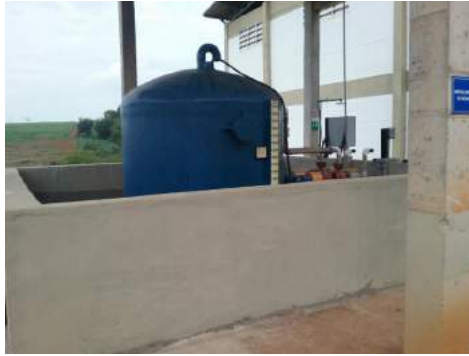
Descrição(9): Tanque de hipoclorito de sódio
