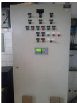
Descrição(5): Detalhe do painel do macromedidor
