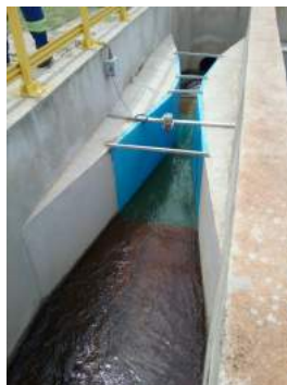
Descrição(12): Calha Parshall de saída do efluente com medidor ultrassônico
