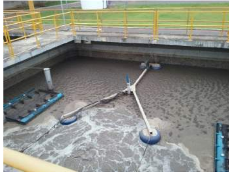
Descrição(5): Reator de lodos ativados em batelada em funcionamento
