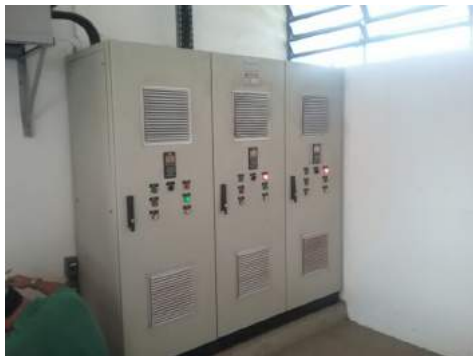
Descrição(4): Painel de comando e operação
