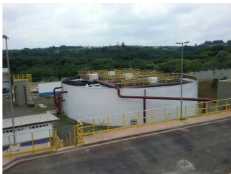
Descrição(4): Vista geral dos reatores anaeróbios e aeróbicos, e decantadores
