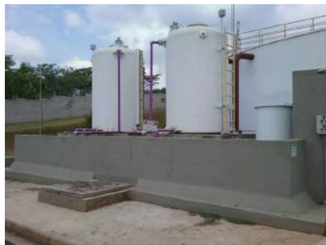
Descrição(16): Tanques de produtos químicos
