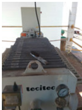
Descrição(4): Filtro Prensa - Desidratação do lodo
