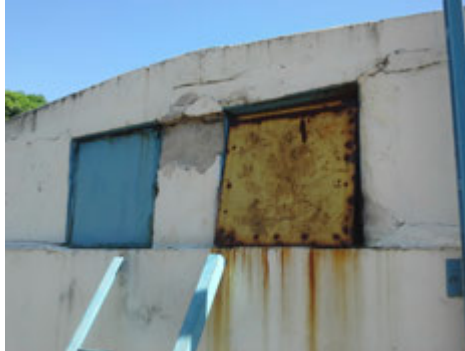
Descrição(5): Detalhes das tampas das inspeções, mostrando uma delas com deficiência na vedação
