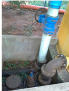
Descrição(9): Detalhe do barrilete de recalque com válvula de retenção e registros e da tubulação de saída para alimentação de um ramal de distribuição
