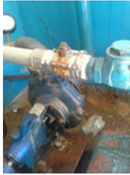
Descrição(4): Detalhe do vazamento em uma das bombas da EEAT
