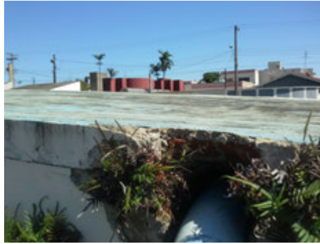
Descrição(4): Vista da cobertura do Reservatório sem tubulação de ventilação
