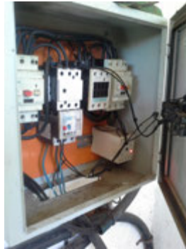
Descrição(5): Vista do interior do Painel Elétrico com proteção convencional simples
