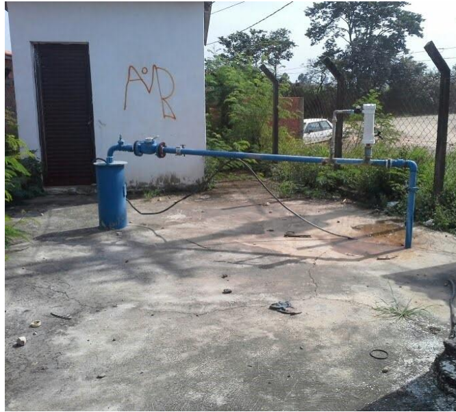
Imagem (2) – Poço, macromedidor, desinfecção e fluoretação
