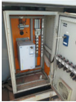
Descrição(1): Painel Elétrico de Comando do Booster
