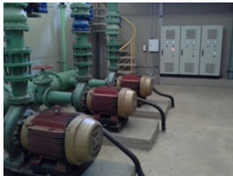
Descrição(10): Vista geral da Casa de bombas
