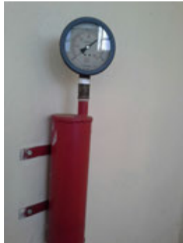
Descrição(8): Manômetro individual para cada conjunto motobomba
