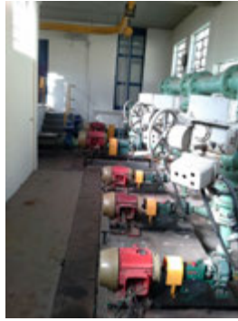
Descrição(7): Outra vista geral da Casa de bombas com 03 EEATs
