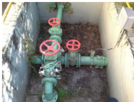
Descrição(13): Caixa de inspeção com barrilete e registros de manobras das vazões de saída.
