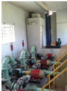
Descrição(9): Outra vista da Casa de bombas mostrando a acessibilidade com escadas com corrimões, boa iluminação e facilidade da monovia com talha para sacar e retirar os conjuntos motobombas para a sua manutenção
