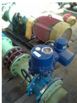
Descrição(10): Válvula automatizada de controle das vazões por telemetria
