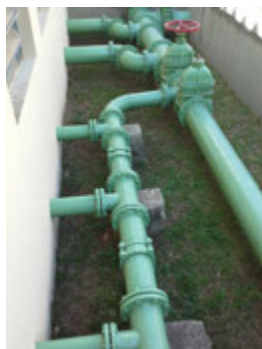
Descrição(10): Vista Geral do barrilete de alimentação das EEATs
