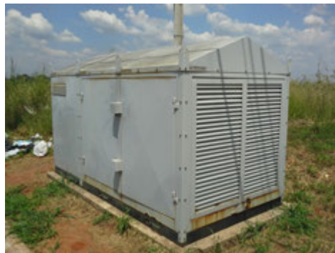
Descrição(7): Casa de bombas modular metálica que abriga o Booster
