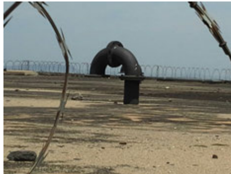
Descrição(9): Detalhe de uma tubulação de ventilação
