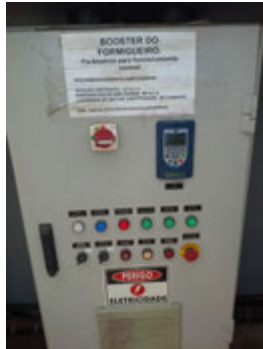
Descrição(2): Outra vista do painel de comando elétrico com detalhes dos comandos
