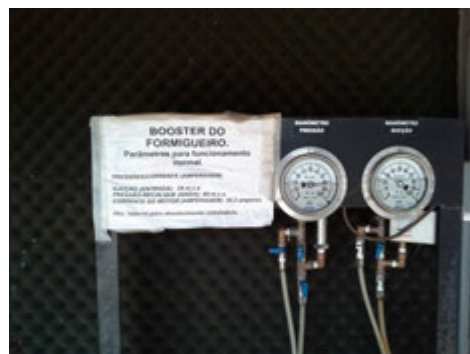
Descrição(4): Manômetros de pressão e outro de sucção
