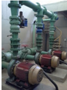
Descrição(9): Os Conjuntos motobombas da EEAT
