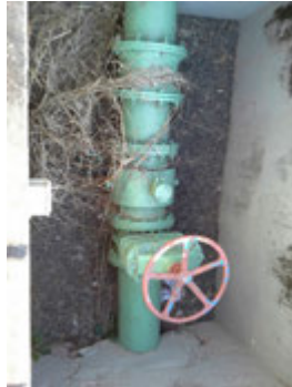
Descrição(12): Registro de manobras e válvula de retenção
