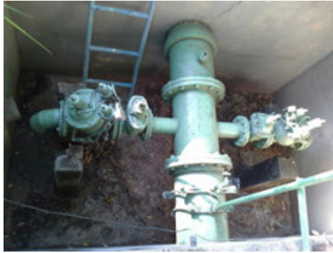
Descrição(11): Válvulas de proteção antigolpe na linha da tubulação de recalque na saída das EEATs
