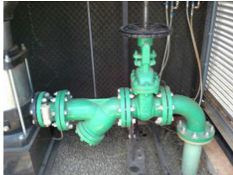
Descrição(6): Detalhe do Registro de manobras
