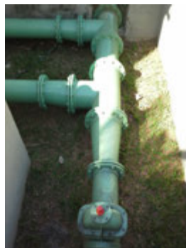
Descrição(9): Barrilete da tubulação de alimentação das EEATs Imagem(10)
