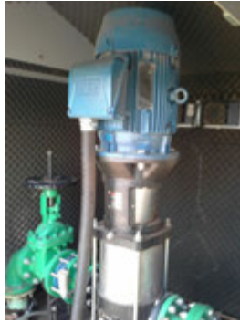
Descrição(5): Detalhe do Conjunto motobomba do Booster
