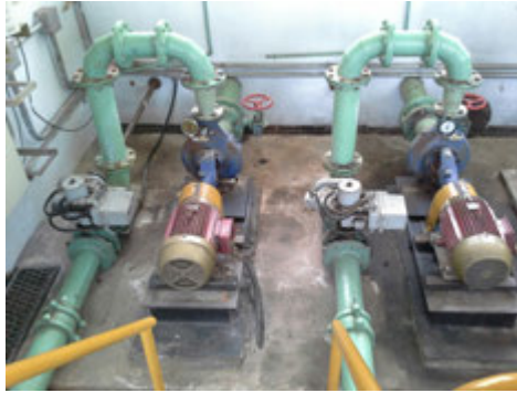
Descrição(7): EEAT - Reservatórios do Campestre- 02 Conjuntos motobombas de 25 CV cada um Imagem(8)
