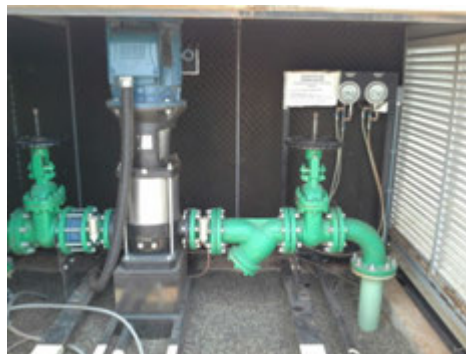
Descrição(3): Vista interna da casa de bombas modular compacta, mostrando o conjunto motobomba, barrilete da tubulação hidráulica com as válvulas e registros de manobras
