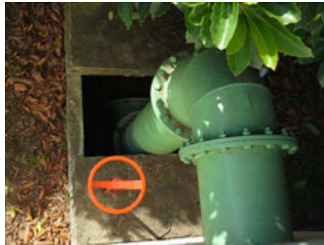
Descrição(7): Tubulação do extravasor e descarga de fundo com registro dentro da caixa de inspeção Imagem(8)
