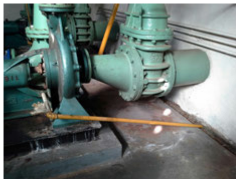
Descrição(9): Excesso de água de lubrificação da gaxetas em uma das bombas
