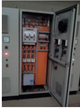
Descrição(8): Vista interna de um dos Painéis Elétricos de Comando
