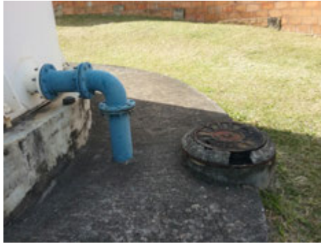
Descrição(4): Tubulação de saída para a distribuição de água para o Condomínio residencial fechado Imagem(5)
