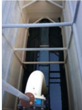
Descrição(16): Saída da água tratada para a EEAT - local
