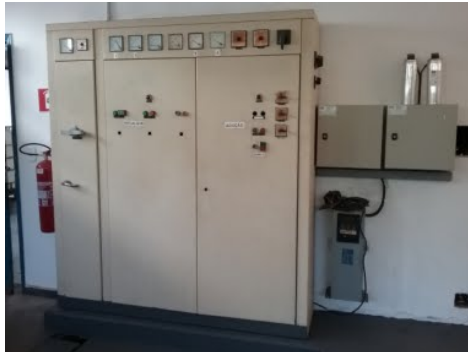
Descrição(12): Painel elétrico de comando dos conjuntos motobombas da Captação e da Elevatória de água tratada Imagem(13)
