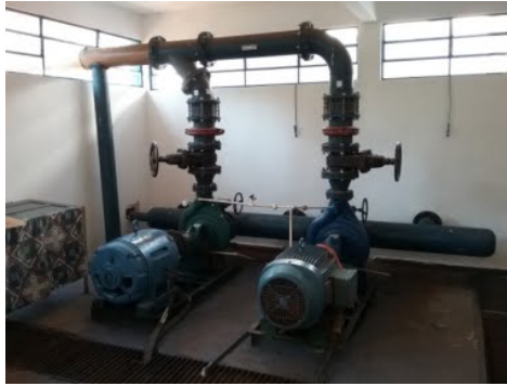
Descrição(11): Conjuntos motobombas da Elevatória de Água Tratada para os Reservatórios de distribuição Imagem(12)
