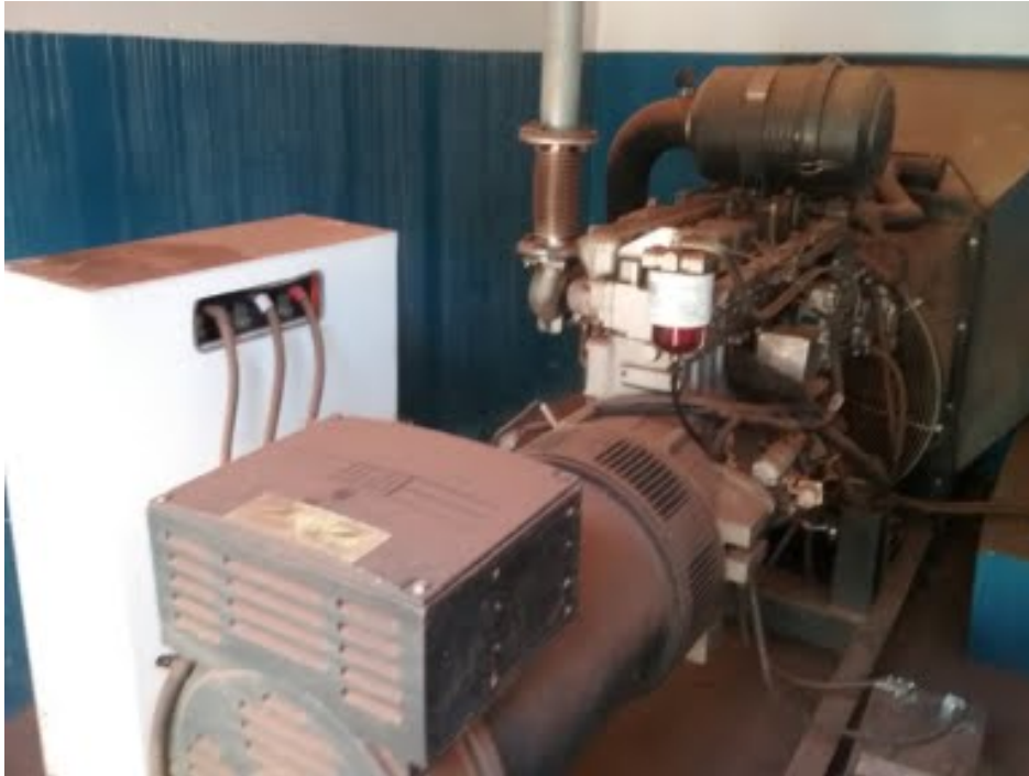
Descrição(2): Gerador de Energia Elétrica à diesel
