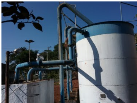
Descrição(13): Filtros (Russos) e tubulação de alimentação do Reservatório de água tratada que por sua vez alimenta a EEAT local para o recalque aos Sistemas de Reservação e distribuição à população Imagem(14)
