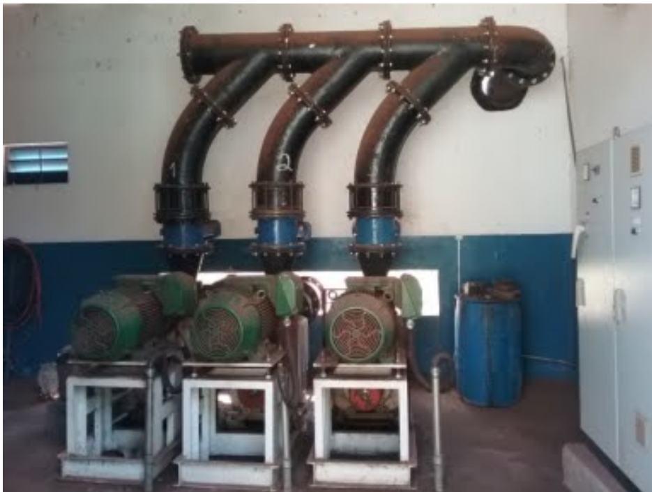
Descrição(3): Conjuntos motobombas da Elevatória de Esgoto Bruto
