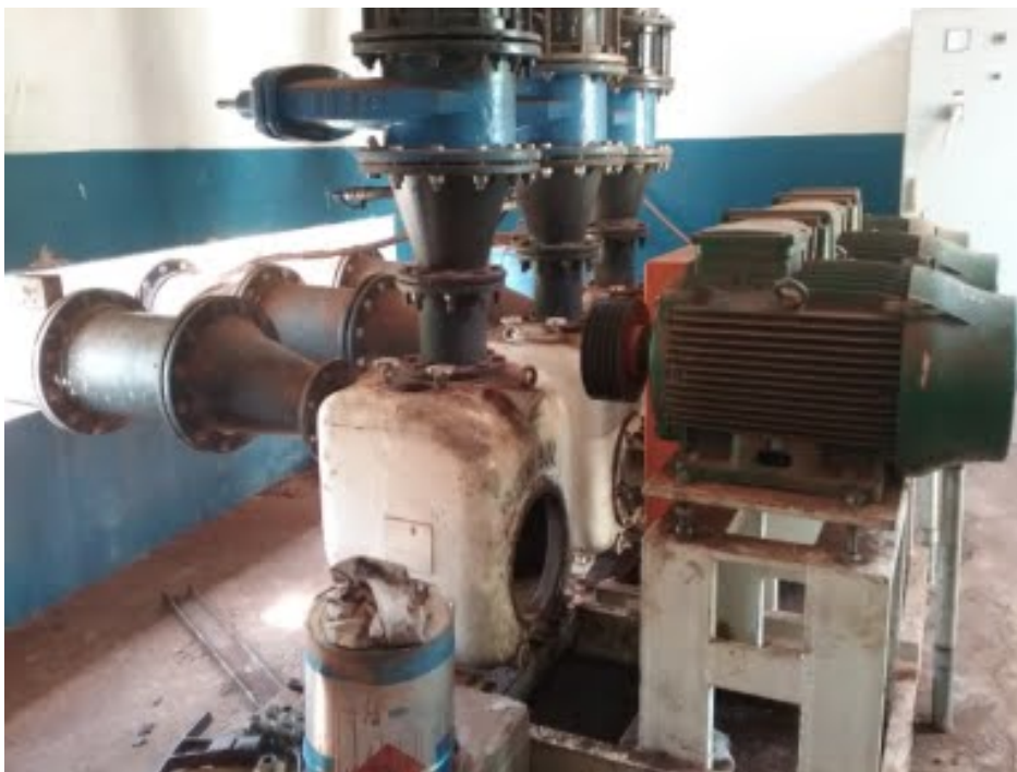
Descrição(5): Detalhes das tubulações de sucção e de recalque e um dos conjuntos motobombas em manutenção
