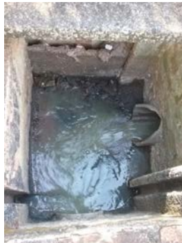
Descrição(8): Caixa de passagem e de entrada do esgoto bruto da área urbana do Distrito de Guarapuã Imagem(9)
