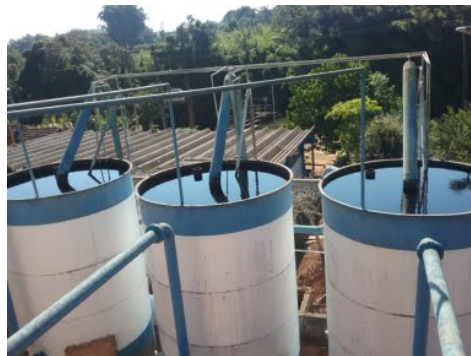
Descrição(17): Vista da superfície dos 3 Filtros Russos
