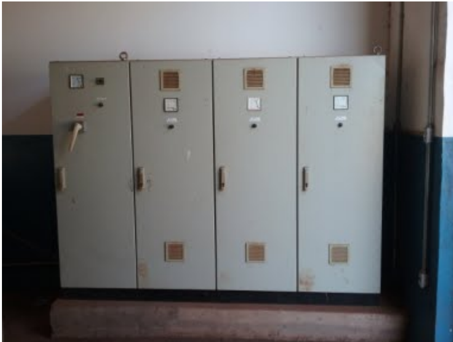
Descrição(4): Painei Elétrico dos conjuntos motobombas da Elevatória
