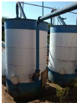
Descrição(14): Detalhes das tubulações de entrada da água nos filtros de fluxo ascendente que recebem a água do decantador
