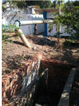
Descrição(16): Caixa de inspeção com registro e tubulação de recalque da água tratada para a distribuição
